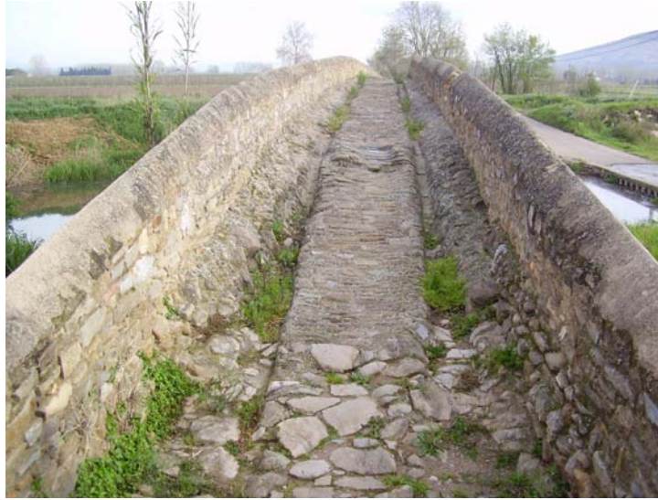
Imagen 10.4 Calzada vista desde el margen derecho. Observar las huellas dejadas por la circulación de los carros.
