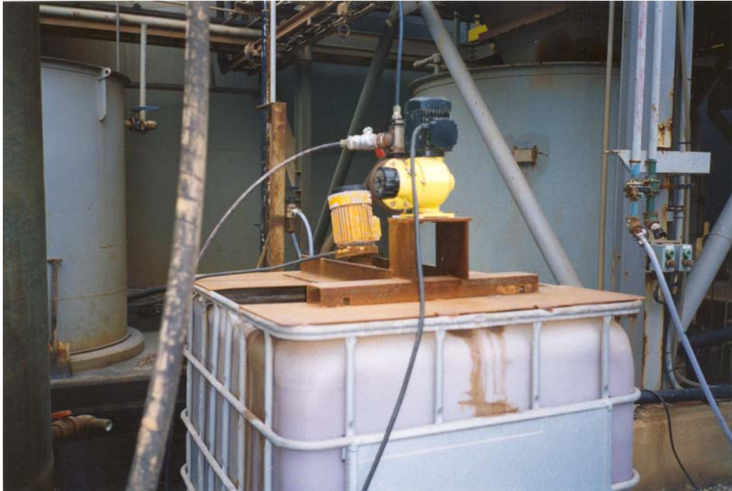
Figura 6.9.- Tanque y bomba dosificadora de permanganato
