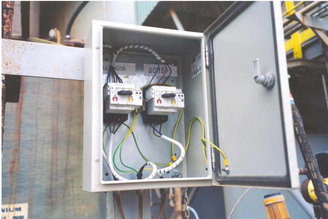
Figura 6.8.- Cuadro eléctrico para la instalación de bomba y agitador
