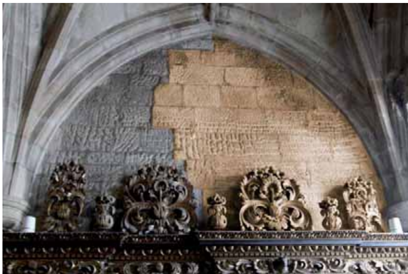
Fig. 65 - Vista del derrumbe de la fachada desde el interior del coro alto. Carlos Alves.
