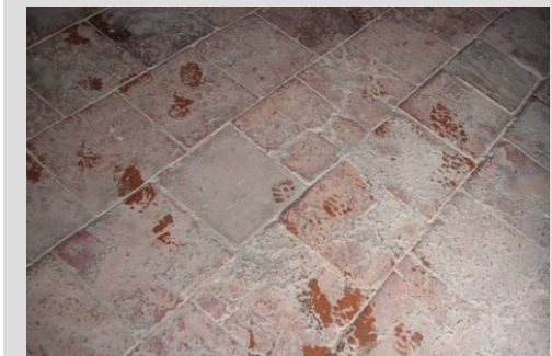
Fig. 38 Fisuración del solado
