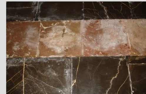
Fig.39 Eflorescencias (Humedad por capilaridad)
