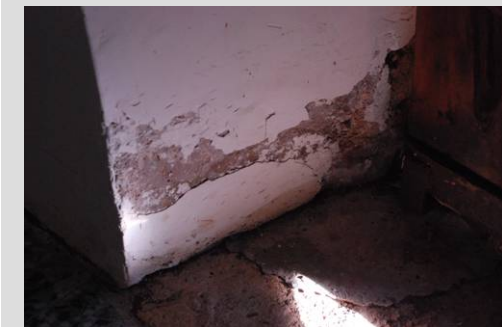
Fig. 34 Desconchado junto a la puerta de acceso
