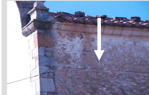
Fig. 32 Fisura vertical muro epístola
