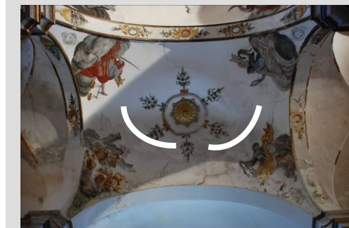
Fig. 38 Fisura meridianos, nave central
