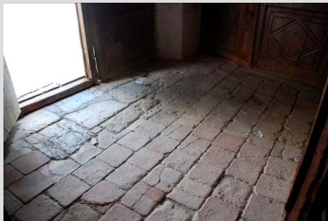
Fig. 40 Fisuras y rotura solado
