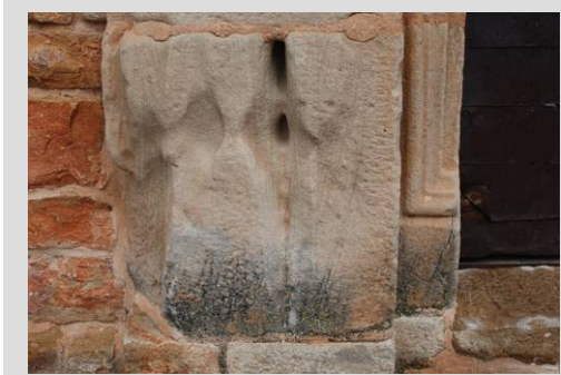
Fig. 36 Disgregación y ennegrecimiento
