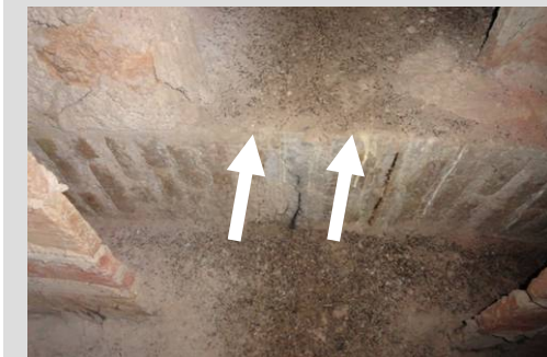
Fig. 56 Fisura arco fajón (zona bajo cubierta)
