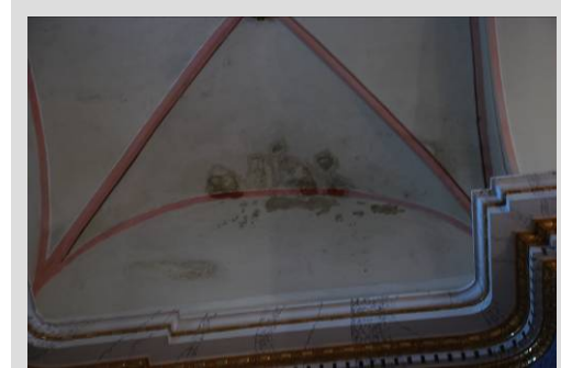
Fig. 40 Manchas de humedad (tramo pies- lado epístola)
