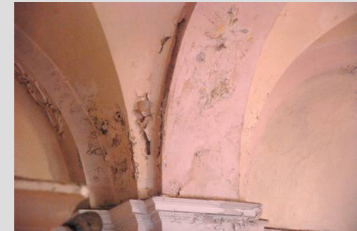
Fig. 41 Humedad por filtración de agua a través de la cubierta (l. evangelio)
