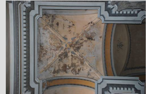
Fig. 60 Desconchado por filtración de agua
