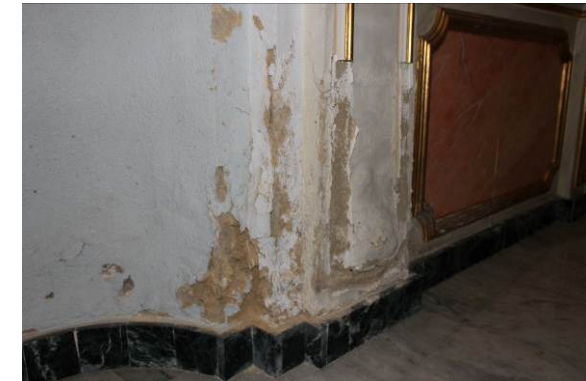
Fig. 12 Humedad por capilaridad (capilla)
