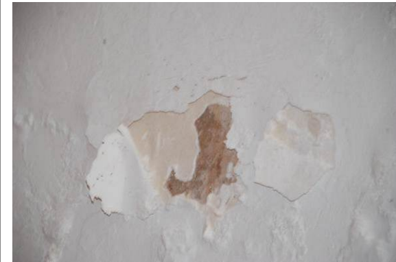
Fig. 201 Humedad por capilaridad
