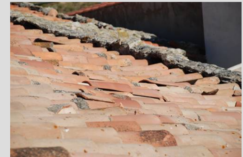
Fig. 67 Hundimiento de la cubierta
