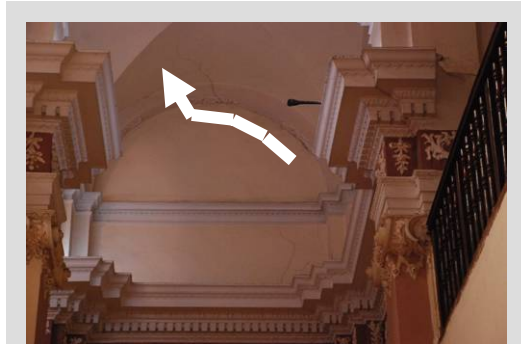
Fig. 40 Fisura entre muro y arco (tramo 2, lado epístola)
