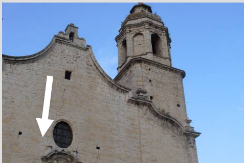
Fig.35 Fisura exterior (brazo)
