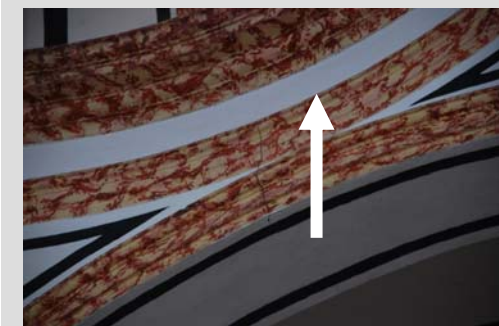
Fig. 46 Fisura arco toral
