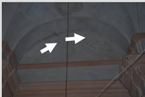
Fig. 62 Fisura de contorno
