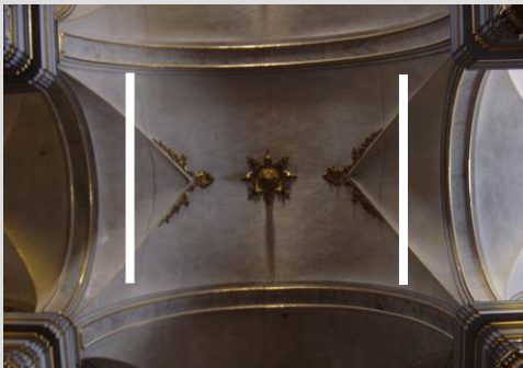
Fig. 75 Fisura a 1/3 (Vila-real)
