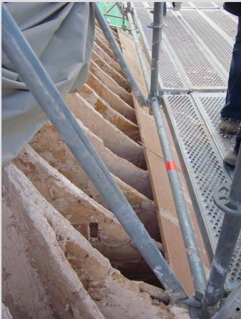
Fig. 59 Separación entre las calotas de la cúpula (Vila-real)
