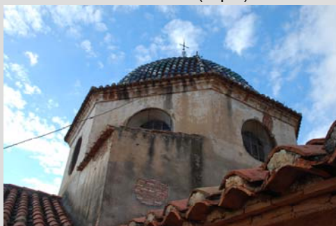
Fig. 51 Pérdida de material (Revoco exterior), chorretones
