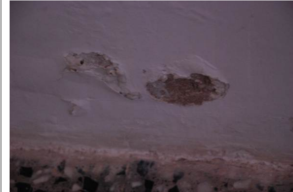
Fig. 165 Humedad por filtración
