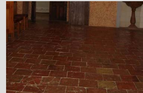
Fig. 37 Rotura solado sacristía (Baldosa hidráulica)
