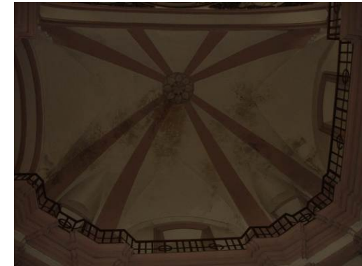
Fig. 48 Humedades por filtración
