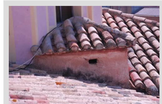
Fig. 31 Revoco y pintura de restauración y antiguos
