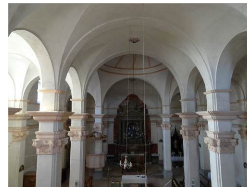
Fig. 174 Vista general: abovedamientos
