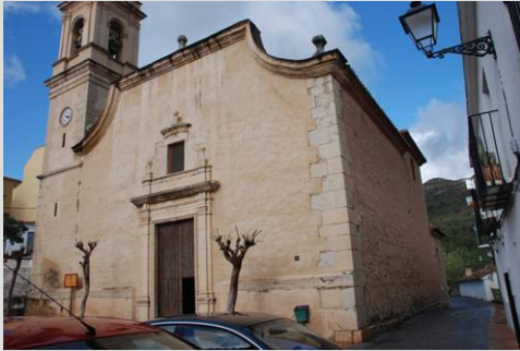
Fig. 29 Pátina cornisas y cota inferior muro
