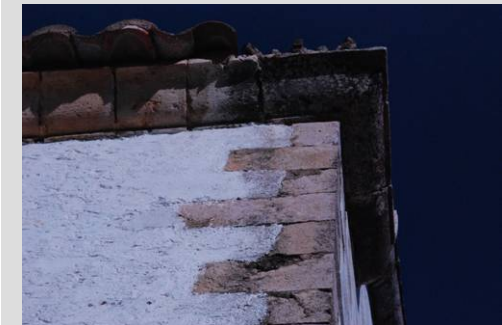
Fig. 33 Ennegrecimiento bajo cornisa
