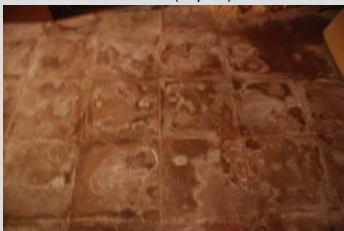
Fig. 50 Humedad por capilaridad: Eflorescencias (cripta)
