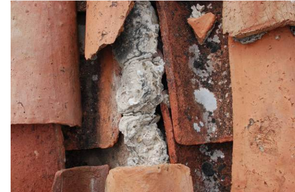
Fig. 69 Fisura cúpula y arco fajón
