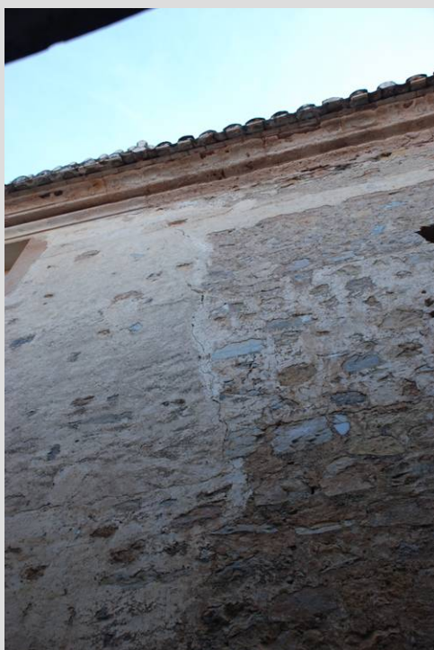
Fig. 59 Fisura que marca las distintas fases de la capilla
