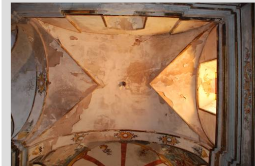
Fig. 43 Desconchados por filtración de agua
