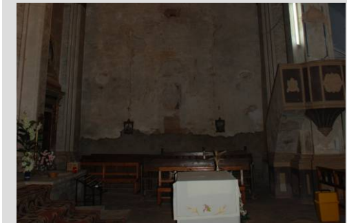
Fig. 37 Humedad por capilaridad
