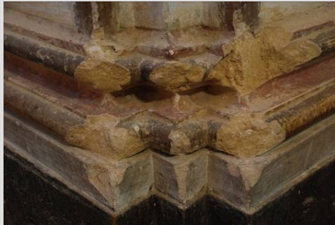
Fig. 45 Pérdida esquinas molduras
