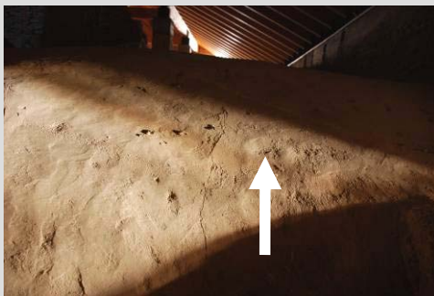
Fig.45 Fisura en una bóveda lateral
