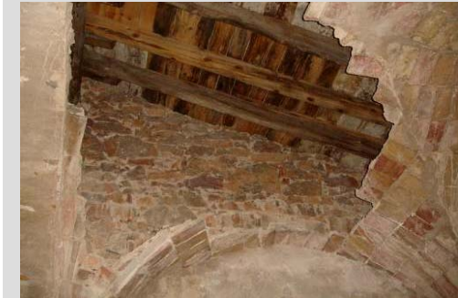
Fig. 42 Hundimiento bóveda almacén coro
