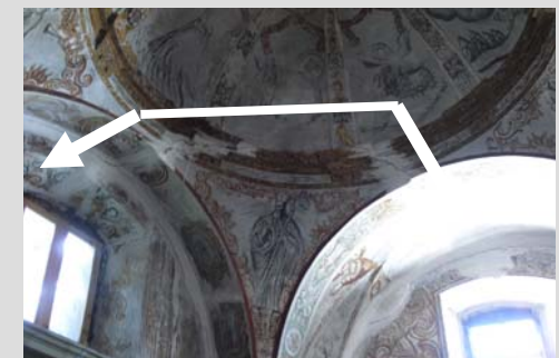
Fig.35 Fisuras bóvedas (trasagrario)
