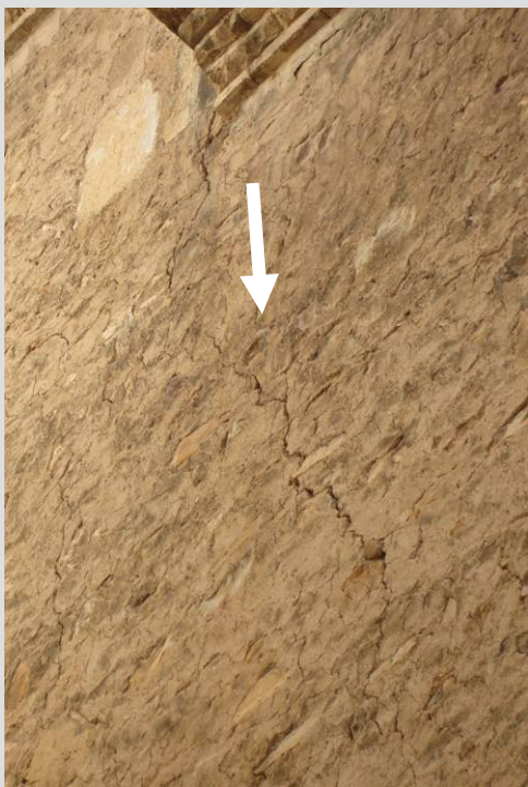
Fig. 39 Fisura vertical exterior (entre brazo y nave, lado evangelio)
