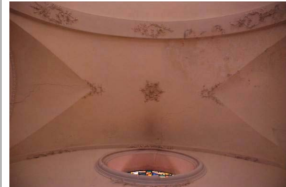
Fig. 117 Fisuras y filtraciones
