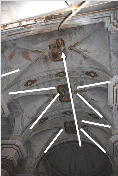
Fig. 34 Fisuras y desconchados
