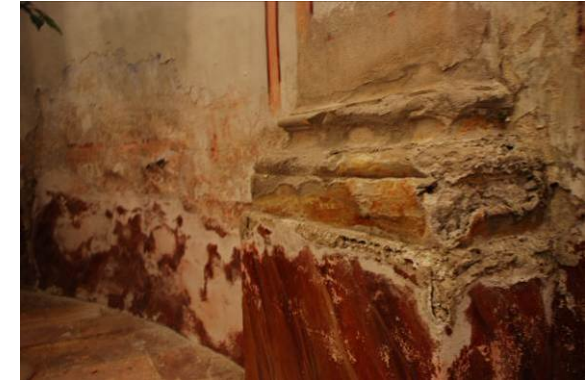
Fig. 24 Disgregación del revestimiento
