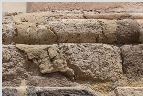
Fig.47 Disgregación pétreo exterior
