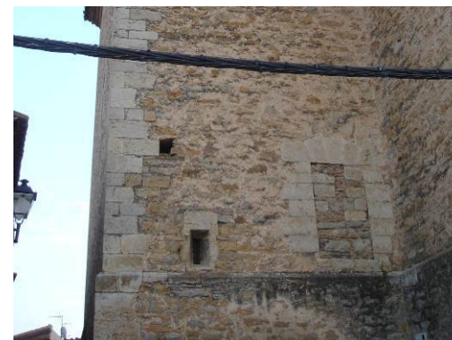
Fig. 39 Vano sacristía tapiado
