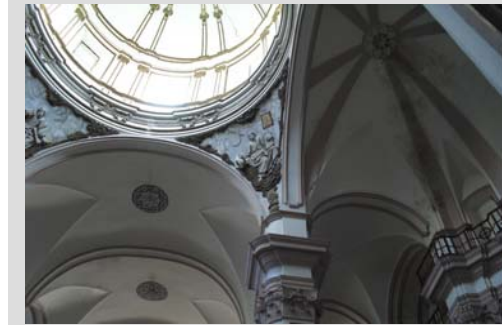
Fig. 36 Cercos de humedad por filtración (Brazos y naves)
