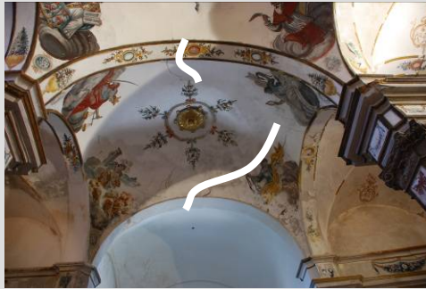
Fig. 74 Fisuras según paralelos (Castell de Cabres)
