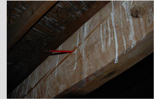
Fig. 64 Fendas en la madera de cubierta
