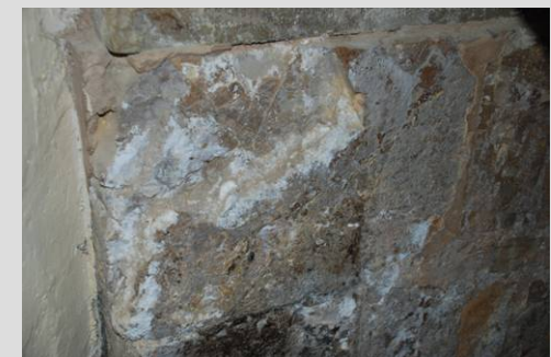
Fig. 63 Desprendimiento por eflorescencias
