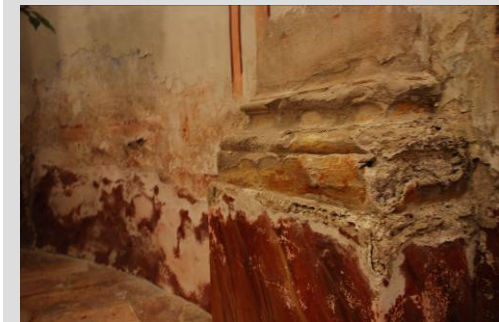
Fig. 41 Disgregación mortero recubrimiento (presbiterio)
