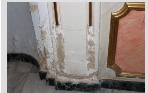
Fig. 48. Humedad por capilaridad (capilla lado evangelio)
