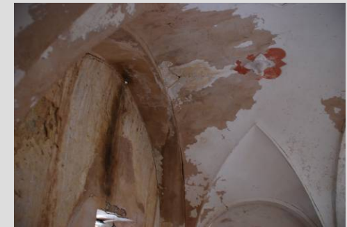
Fig. 57 Desconchado bóveda y pared
