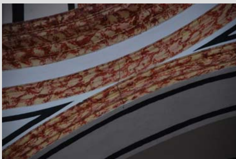
Fig. 42 Fisura arco toral
