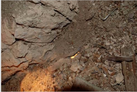
Fig. 39 Fisura arco fornero crucero
