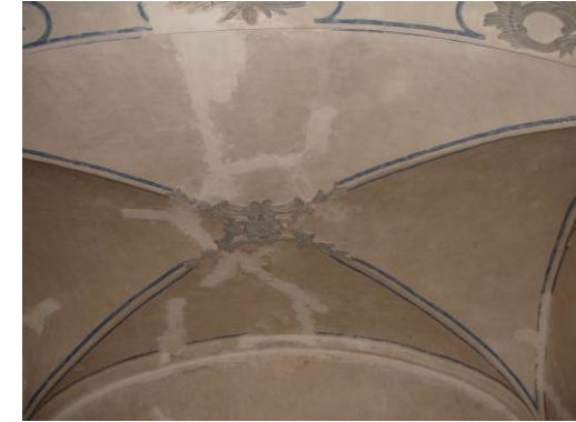
Fig. 81 Fisuras naves laterales
