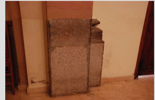
Fig. 42 Humedad por capilaridad (pies)
