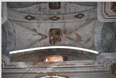
Fig. 35 Fisura de contorno ennegrecimiento
