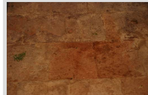
Fig. 42 Disgregación baldosas barro cocido
