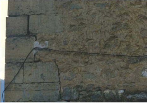
Fig.43 Fisura entre encadenado y mampostería (Martín 1998)
