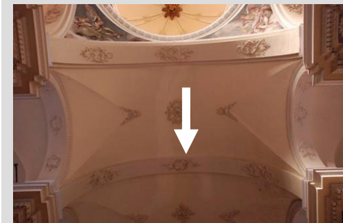
Fig. 37 Fisura en el eje de la bóveda central
