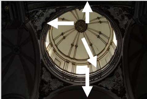
Fig.34 Fisuras en bóvedas
