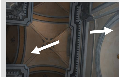
Fig. 57 Fisuras a forma 45^\circ y verticales
