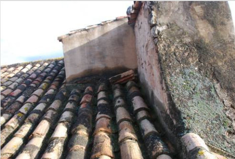
Fig. 30 Pátina sobre las cornisas y humedad en los muros
