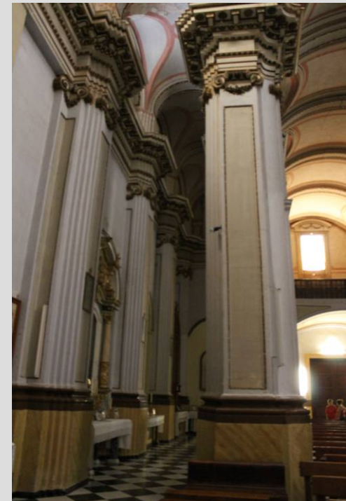
Fig.41 Desplome pilar toral
