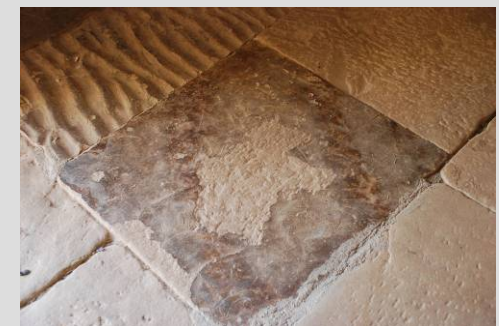
Fig. 59 Desconchado por pérdida de resistencia al desgaste
