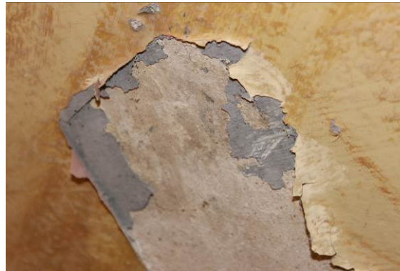
Fig. 104 Capa de pintura anterior (cancela)
