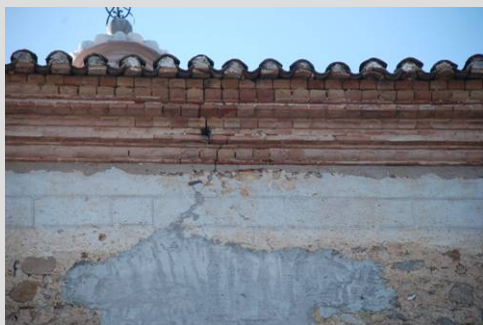
Fig. 58 Fisura en el centro de la fachada posterior
