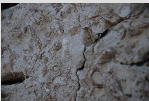
Fig. 63 Fisuras verticales que atraviesan el mortero de agarre (hastial posterior)
