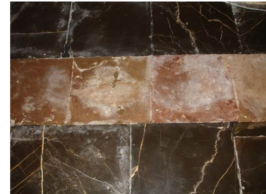
Fig. 189 Eflorescencia en solado
