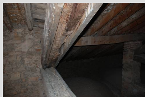
Fig. 70 Humedad por capilaridad
