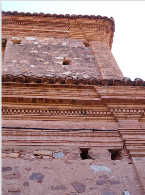
Fig. 46. Fisura exterior (brazo)
