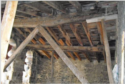
Fig.36 Hundimientos techumbre de la torre
