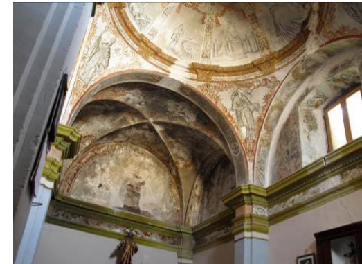
Fig. 93 Fisuras y desprendimiento (trasagrario)
