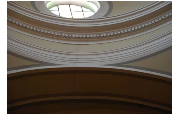
Fig. 57 Fisura cúpula y arco toral
