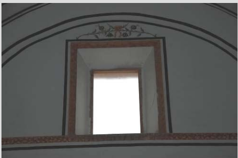
Fig. 14 Derrame o abocinado (Vinaròs)
