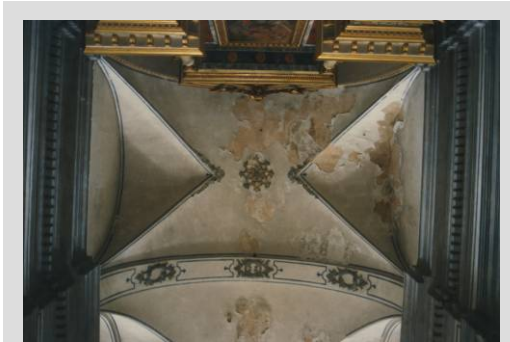
Fig.46 Desconchados por filtración (Martín 1998)
