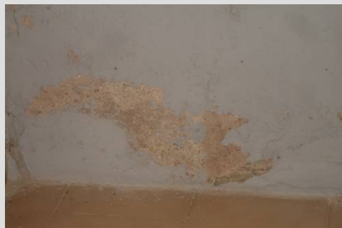
Fig. 69 Humedad por filtración
