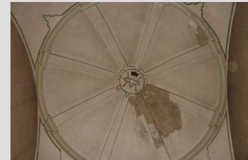
Fig.38 Desconchado (Humedad por filtración)
