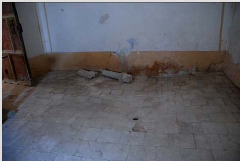
Fig. 41 Hundimiento solado (almacén)
