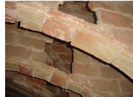
Fig. 129 Control de fisuras en al torre
