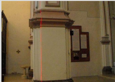
Fig. 76 Desplome de todos los pilares (Cincorres)
