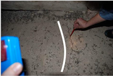
Fig. 73 Fisura radial, cúpula (Culla)
