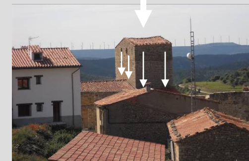
Fig.34 Fisuras verticales (torre) Hundimiento de la cubierta
