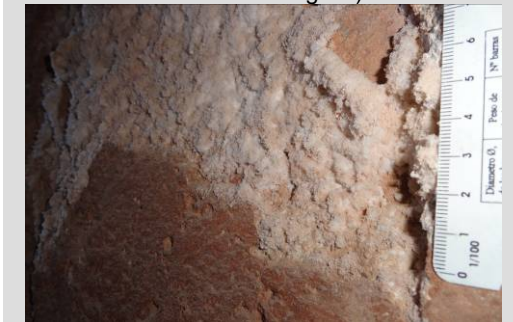
Fig. 49. Eflorescencia en la torre
