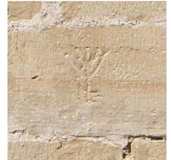
Santa Maria de Montblanc, marca de picapedrer de la façana, s. XIV
