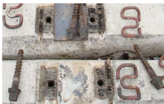
Estado de los elementos metálicos de la sujeción
