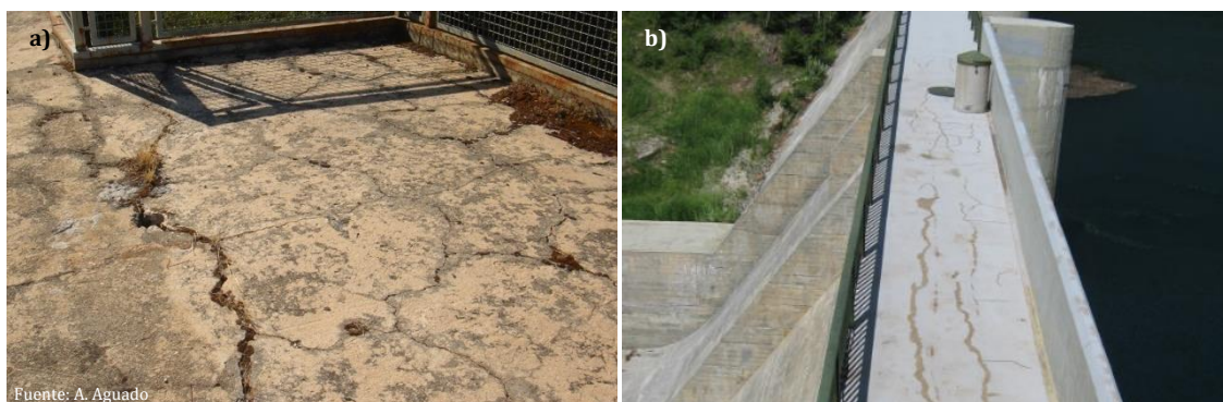
Figura 3.15.- Fisuración en coronación
