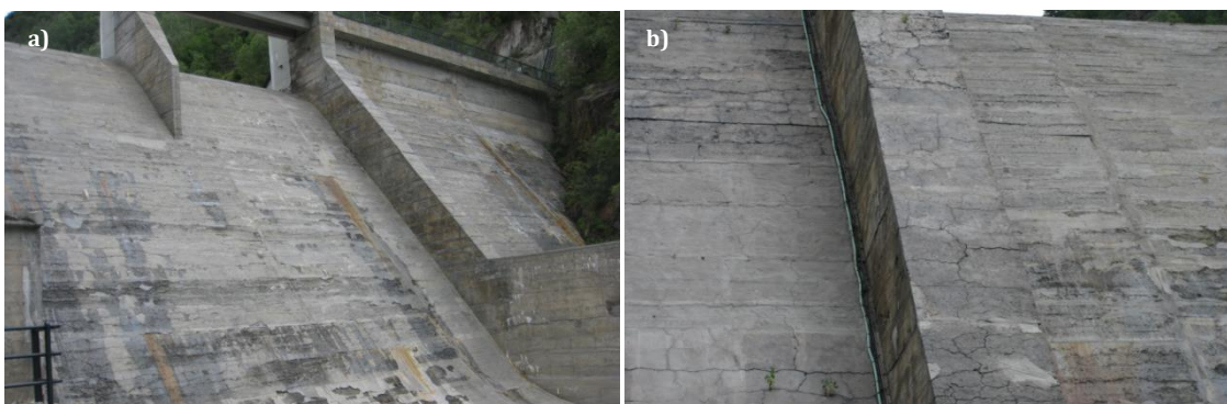
Figura 3.17.- Signos de daño en paramento aguas abajo y aliviadero
