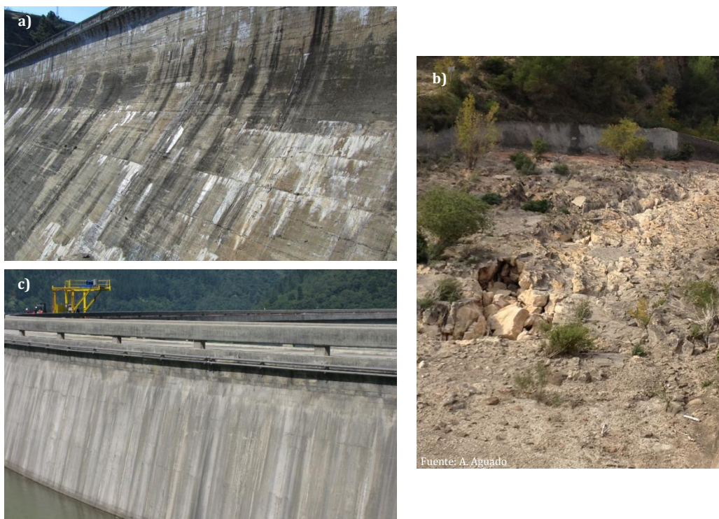
Figura 2.6.- Daños causados por: a) reacción expansiva; b) erosión; c) efectos térmicos
