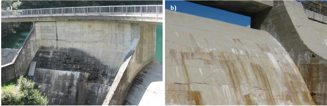
Figura 3.18.- Signos de daño en paramento aguas abajo y aliviadero
