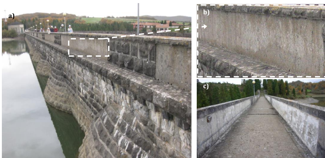
Figura 4.11.- Estado de conservación del muro-barandilla
