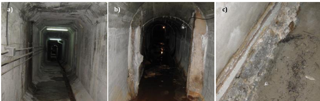
Figura 3.22.- Estado de diferentes galerías de una misma presa
