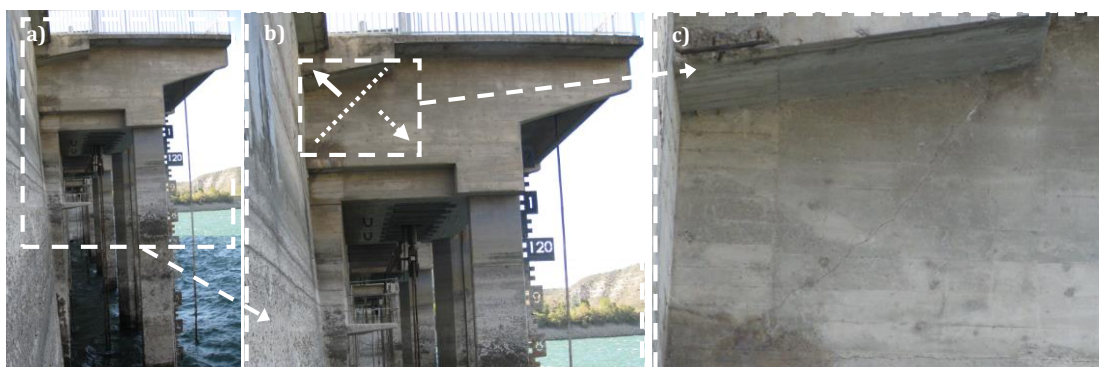
Figura 3.21.- Fisuración por corte directo; a) imagen general; b) y c) detalle fisura
