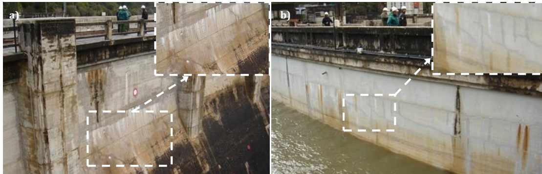
Figura 3.11.- Fisuras inclinadas; a) paramento aguas arriba; b) paramento aguas abajo
