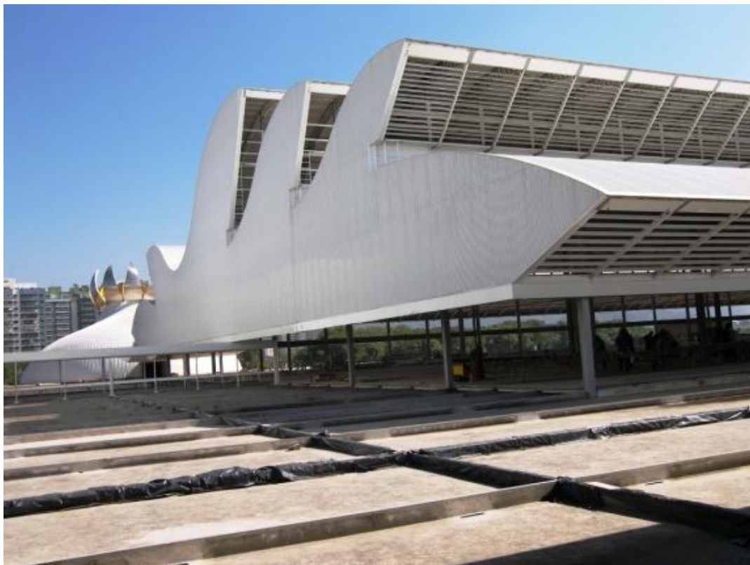
Figura 2.101 – H. Sarah Rio de Janeiro - Fachada sur y este - vista exterior - fase de obra (archivo del CTRS)
