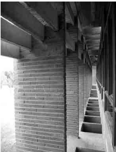
Fig. 130 Vista de detalle del espacio intermedio entre los parasoles del hospital y su fachada Oeste. En la imagen se observa la disposición de los parasoles horizontales de hormigón armado prefabricado, de los parasoles verticales de fábrica de ladrillo visto de mortero de cemento y de las carpinterías exteriores de madera de pino vista y barnizada en su color natural. Fotografía actual.
