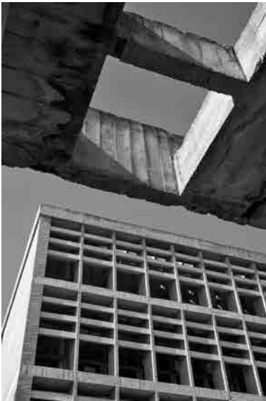
Fig. 129 Vista de detalle de la celosía obtenida al dejar huecos los casetones del forjado reticular y del despiece de tablillas de su encofrado. Fotografía actual.
