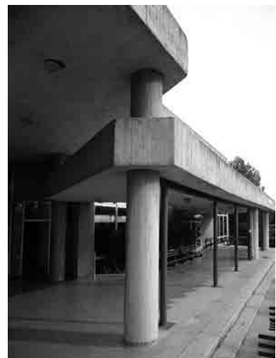
Fig. 75 Apuntalamiento permanente de algunos forjados debido a la alarmante flecha que presentan. En la imagen, el porche del edificio del teatro-cafetería. Fotografía actual.
