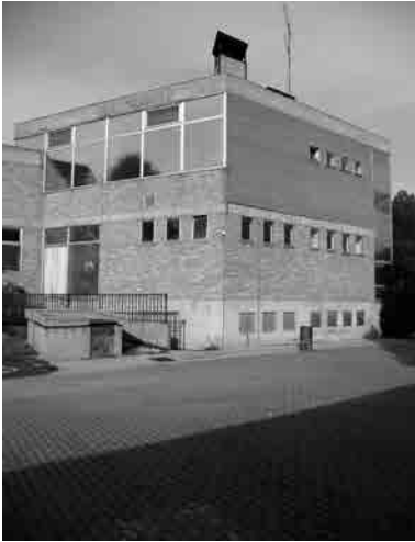
Fig. 76 Diferencia de color y textura entre los cerramientos originales de ladrillo visto y los reconstruidos a causa de su fractura. En la imagen, el edificio de comedores-cocinas. Fotografía actual.
