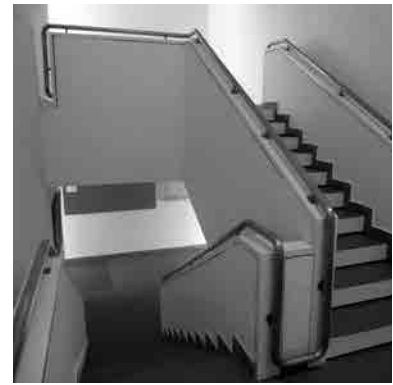
Fig. 71 Utilización de un tubo igual al de las conducciones de agua como pasamanos en las escaleras de las residencias. Fotografía actual.
