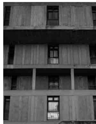
Fig. 33 Vista de detalle de las placas de hormigón prefabricado que constituyen los cerramientos de los edificios. En la imagen, la fachada trasera del cuerpo de dormitorios. Fotografía actual.
