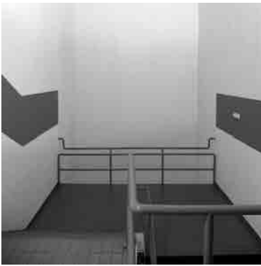
Fig. 75 Utilización de un tubo igual al de las conducciones de agua como pasamanos en las escaleras de las residencias. Fotografía actual.
