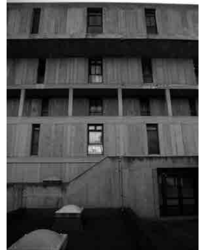
Fig. 11 Vista parcial de la fachada Norte del edificio de residencia del Colegio de Promoción Social de Tenerife. En la imagen se aprecia la composición modular de los paneles de hormigón armado prefabricado que constituyen los cerramientos de los edificios del conjunto.
