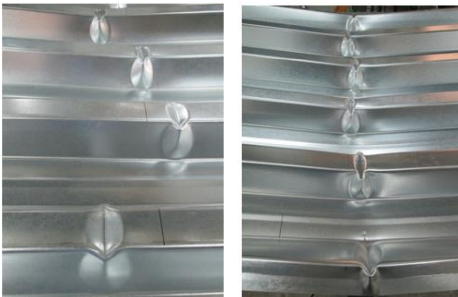
Figura 7.36. Mecanismo de fallo de la chapas sin embutición. PLANA-1 y PLANA-3.
