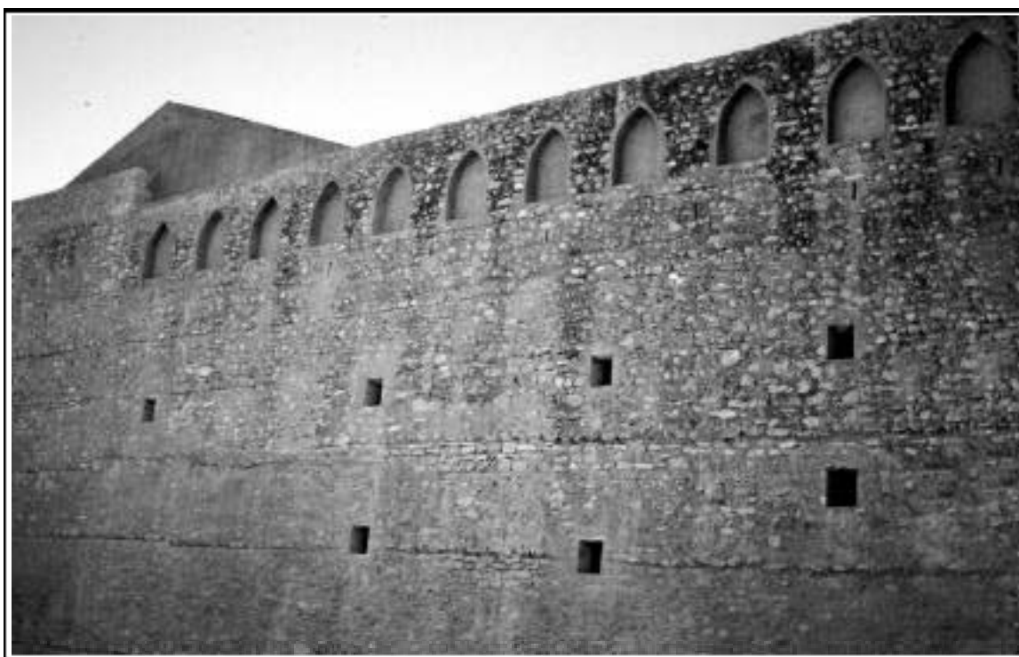
Mur nord-oriental de l'hospital, abans i després de la restauració de 1998, amb les finestres ja reobertes d'acord amb un criteri erroni.
