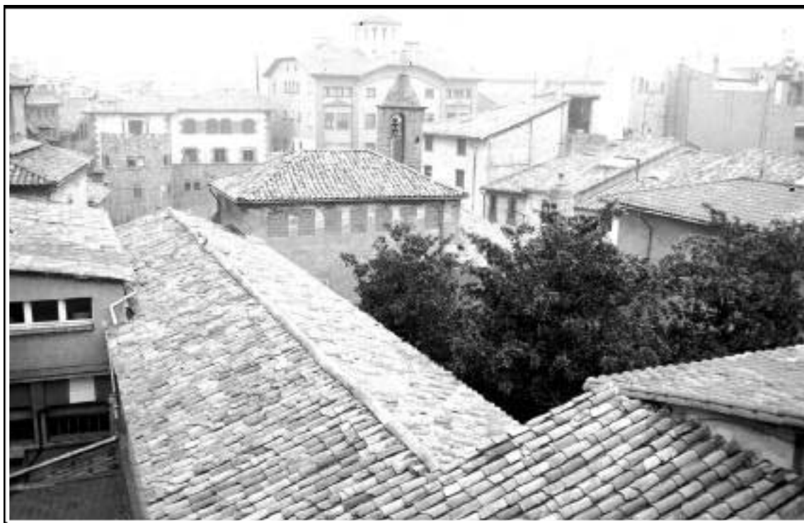
B. Detall de la coberta de la sala medieval de malalts i cos posterior de la façana principal.
