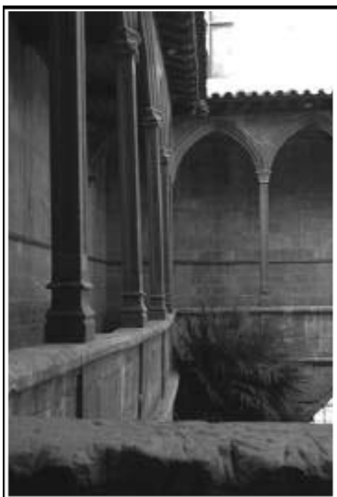
C. Imatge on s'aprecia la desviació que pateix l'ampit de la galeria occidental del pati.
