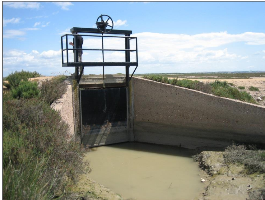
Fig. 10.14. Culvert sluice on the river side of the Montaña del Río.
