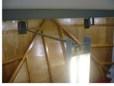
Detalle del interior de la cubierta
