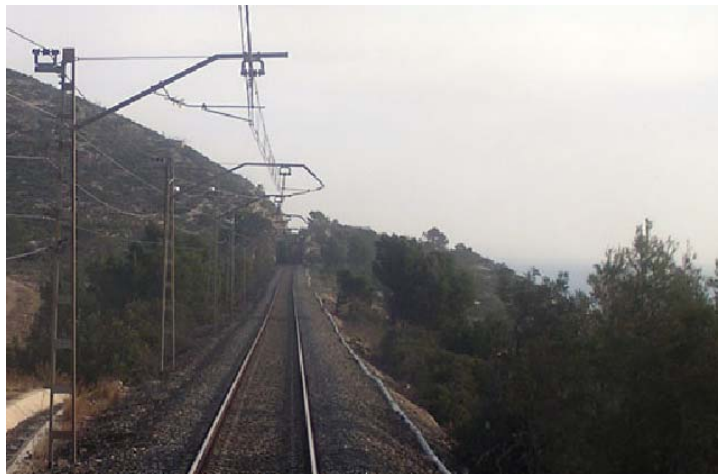
Fig. 9.1. P.K. de la línea donde se produjo la caída
