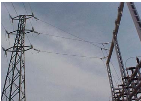
Fig. 11.4 Línea de AT en Corriente alterna que alimenta una subestación convertidora.
