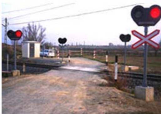
Fig. 3.4. Paso a nivel clase B. Señales fijas, luminosas y acústicas
