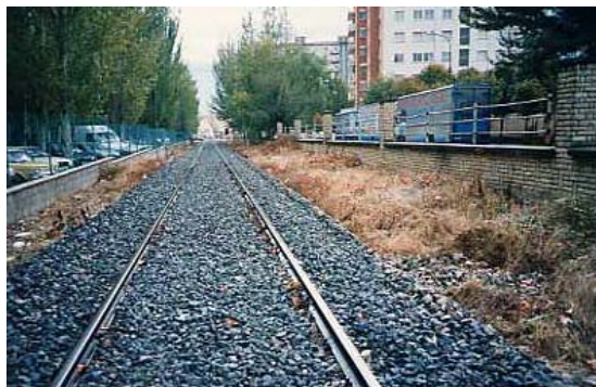
Fig. 7.10 Vía tratada con productos herbicidas
