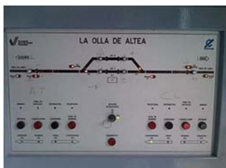
Cuadro de operaciones del bloqueo eléctrico manual
