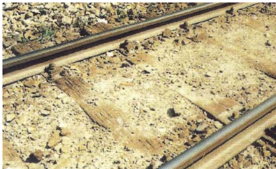
Fig. 6.1 Contaminación de la capa de balasto
