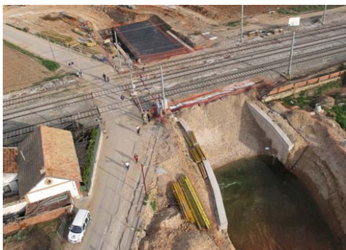
Fig. 4.4 Supresión de un paso a nivel y construcción de un paso inferior al lado.
