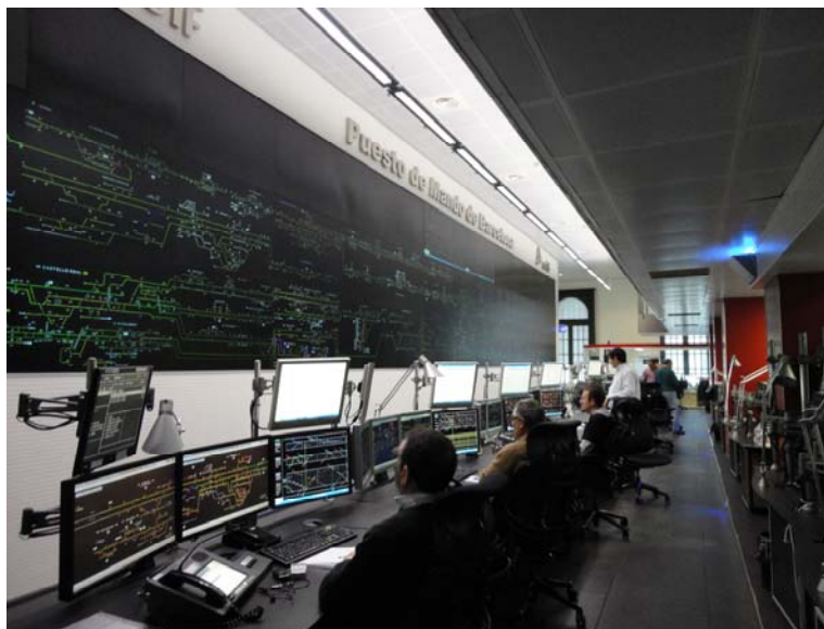
Fig. 5.11. Sala de CTC. (Puesto de Mando de Barcelona).
