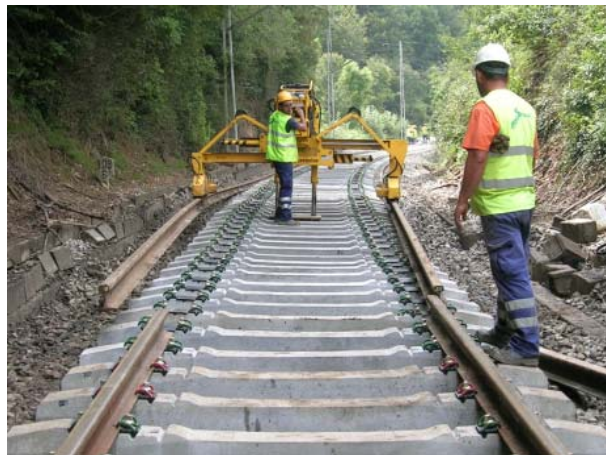
Fig. 6.4 Las nuevas traviesas monobloc
