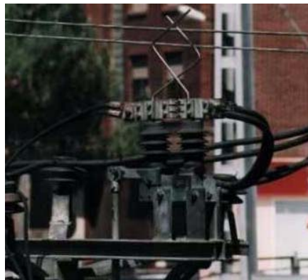
Fig. E. 6 Descargador de antenas
