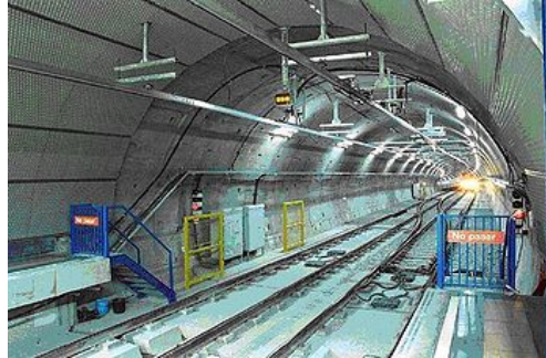
Fig.11.14 Catenaria rígida en transporte subterráneo urbano Fuente: Ferrocarriles Metropolitanos del Dr.ICCP D.Manuel Melis
