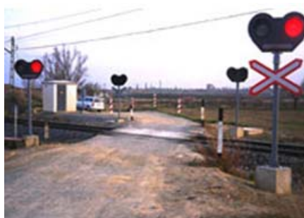
Paso a nivel de clase B, protegido por señales fijas, luminosas y acústicas
