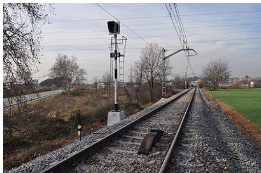
Fig. 5.16. Señal dotada de ASFA 25 .
