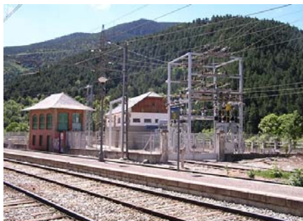
Figura 11.5 Vista de una subestación de línea de montaña. Planotes, Línea de Ripoll a Puigcerdá Fuente: Elaboración propia del autor en visitas de seguridad.
