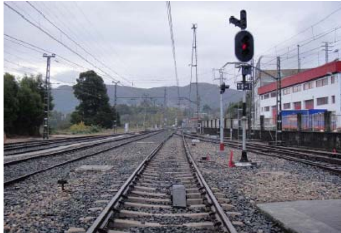
Fig. 10.12 Zona de rebase de señal y talonamiento Fuente: Elaboración propia del autor en sus visitas de inspección de seguridad
