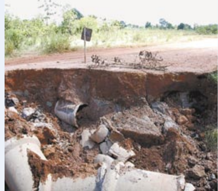
Pontes caíram e várias estradas estão intransitáveis no interior de MS
