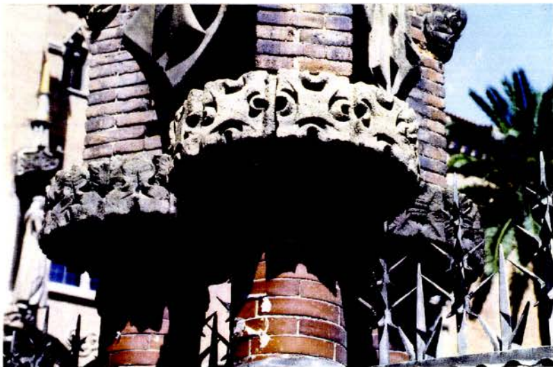
Foto 16 Detall dels capitells que conformen el tancament del recinte de l'Hospital, consistents en collarets de formes vegetals simplificades.
