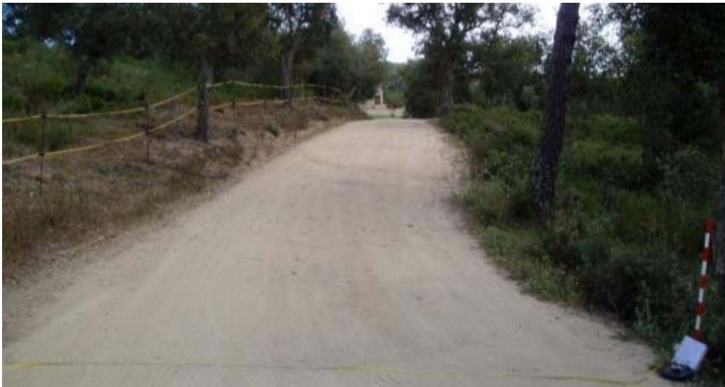
Figura 19. Ejemplo de mantenimiento de camino forestal en la finca de Mas Bassets.
