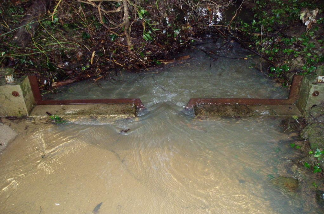
Figura 5. La estación de Bosc totalmente colmatada por sedimento.
