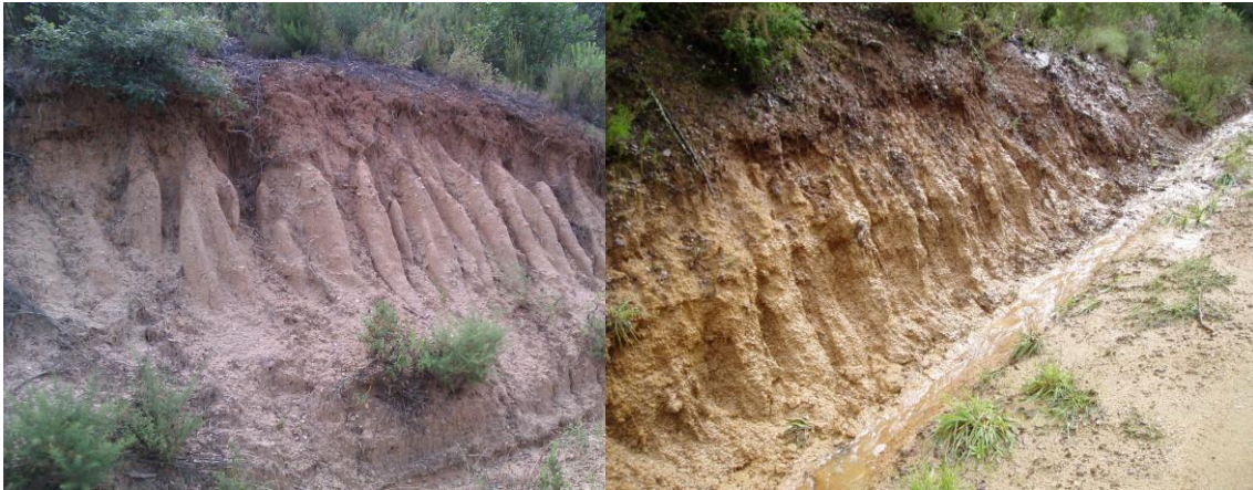
Figura 11. Márgenes de los caminos erosionados por las diferentes precipitaciones.
