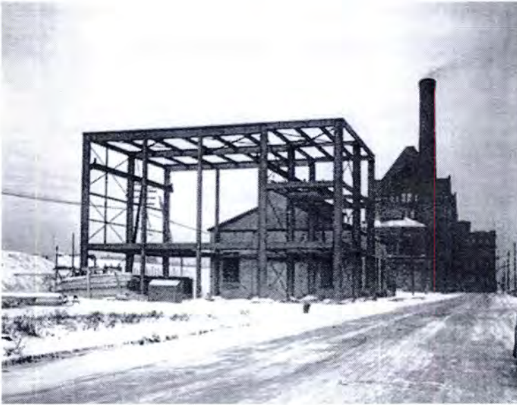
50. Mies van der Rohe. Campus del IIT, estructura de la Boiler Plant en construcción.
