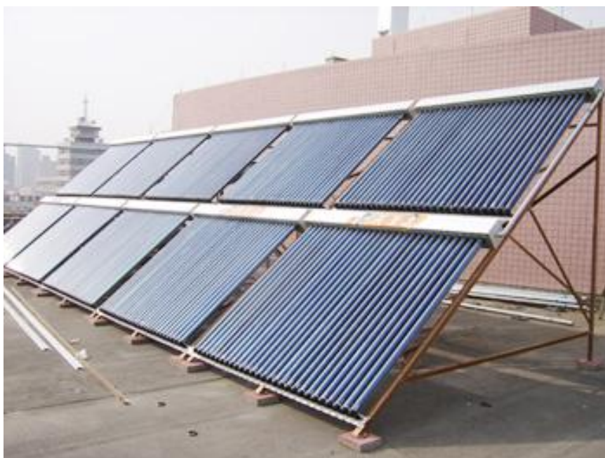
Foto de un sistema de placas solares térmicas.
