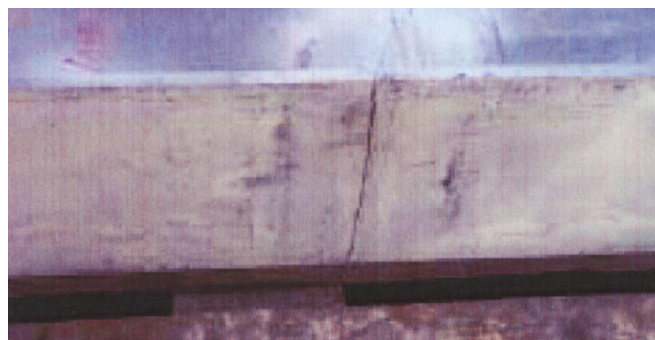
Figura 2.7. Ejemplo de grieta en el ala inferior de un perfil doble T (imagen proporcionada por la Universidad de Kaiserslautern [7]).
