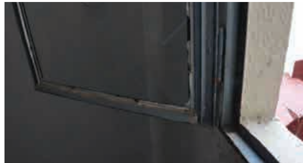
Fig.3.15. Estado actual de las carpinterías embebidas en el panel de hormigón (2012)
