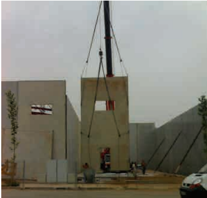
Fig.3.51. Elevación de un panel del sistema de Leiro durante la construcción de una nave industrial.
