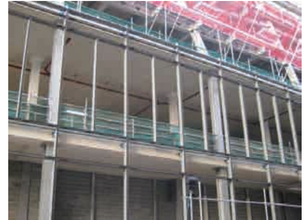
Fig.4.10. Montaje sistema Stick para el edificio One New Change de Jean Nouvel en Londres. 2009
