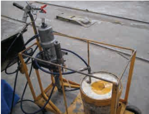
Fig.D1.18a. Bomba para el proyectado del desencofrante
