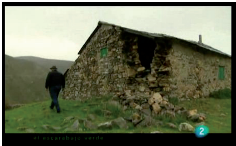
Imagen 15: Cabana derruida por las vibraciones ocasionadas por las explotaciones a cielo abierto
