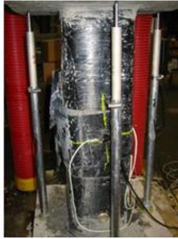
Fig. 3.1 Ejemplo de rotura en la camisa en una probeta reforzada.
