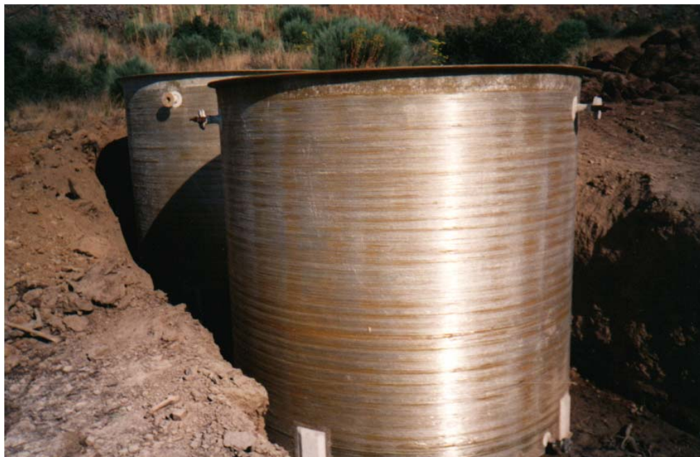
Foto 2.1.2.1.c: Sistema SAPS: Depósitos utilizados como sistemas SAPS dispuestos en serie
