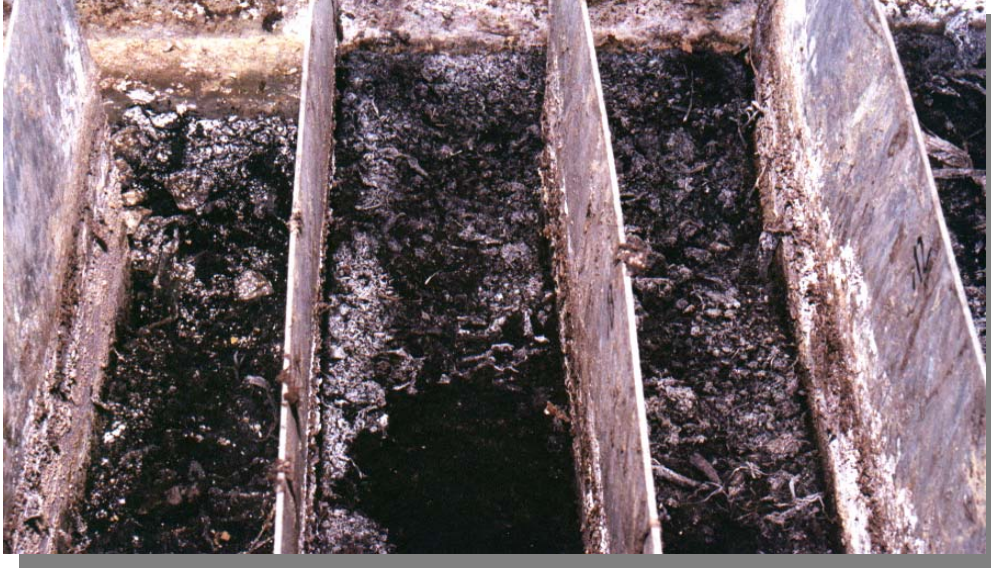
Foto 15.4: Depósitos blanquecinos de sulfatos sobre la superficie del sustrato orgánico en el humedal
