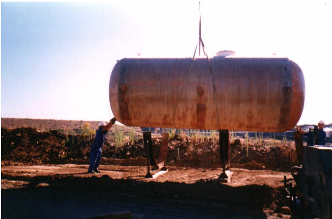
Foto 2.1.2.1.b: Depósito almacén de agua de corta para abastecimiento al Sistema
