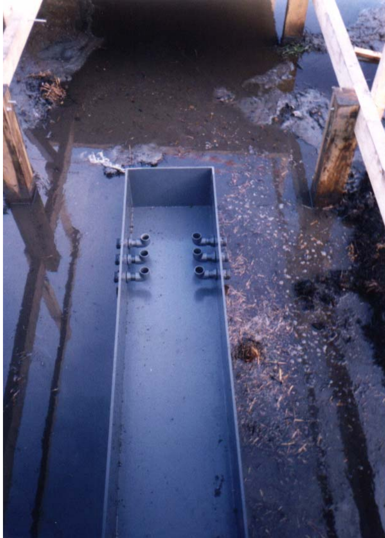
Foto 1.2.2.e: Balsa de sedimentación desde la cual el agua penetra en el humedal a través de seis tuberías
