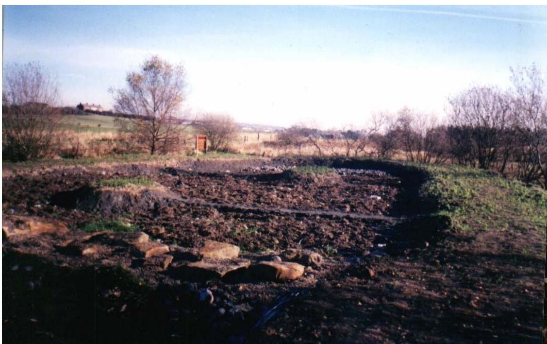
Foto 1.2.2.d: Construcción del humedal. Se aprecian las dos balsas rellenas y una capa de suelo vegetal dispuesta sobre la superficie de los diques e islas, sobre la que se está desarrollando vegetación.
