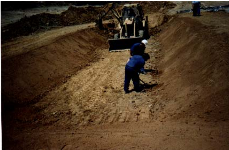
Foto 2.1.2.1.o: Salida de la balsa del humedal. Esta balsa ha sido impermeabilizada mediante una lámina de polietileno y su fondo, protegido con una segunda lámina de geotextil
