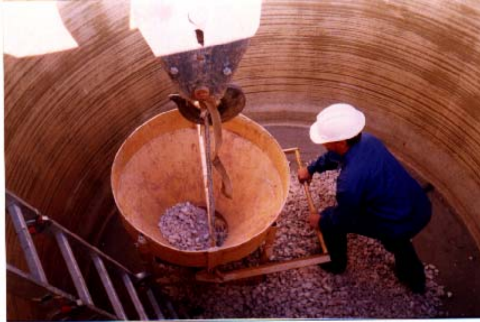
Foto 2.1.2.1.e: Relleno de la capa de caliza en el interior del sistema SAPS
