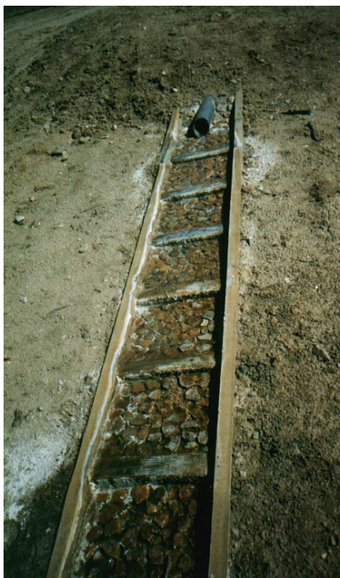
Foto 2.1.2.1.l: Cascada de oxidación
