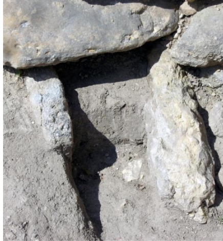
Fig. 137: Vista sud de la canal d'evacuació de l'estança 6 de l'illa VII d'Ensérune (estructura 62).
