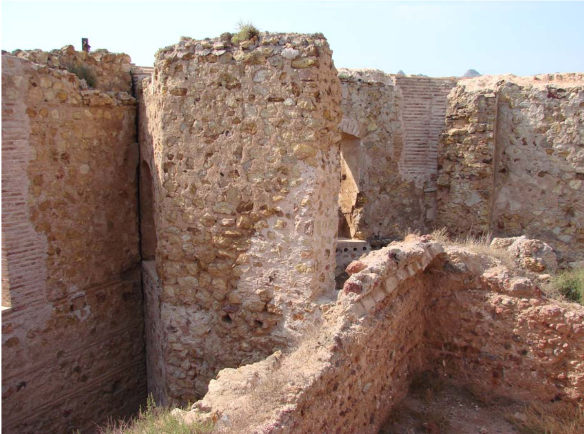
Lám. 241: encuentro de dos fases constructivas en el interior de la fortaleza
