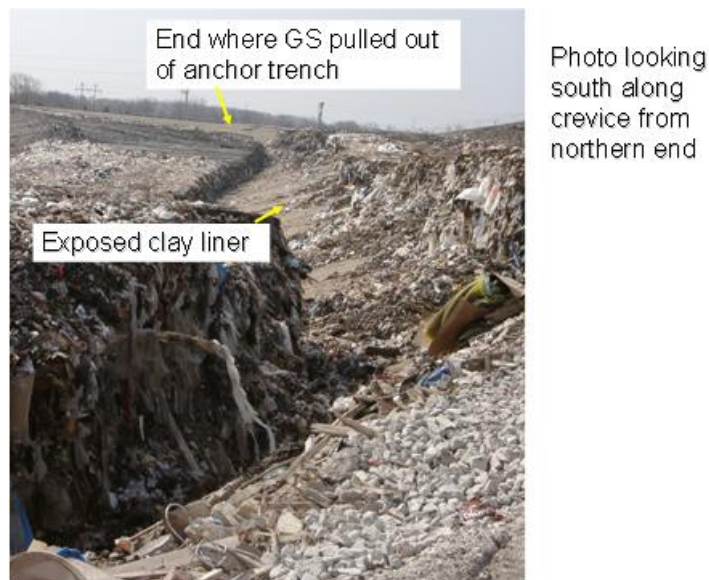
Figura 1.8 Deslizamiento a través de las láminas de impermeabilización
