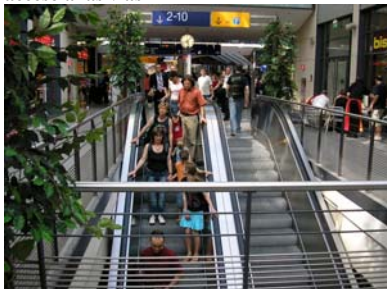
Fig. 8.79. Escaleras mecánicas del vestíbulo al túnel de acceso a las vías
