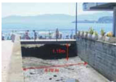
Foto F16.- Fi de la canalització, tapada per la sorra de platja; a la dreta restaurant i a l'esquerra aparcament. (foto PMR, juny 2008).
