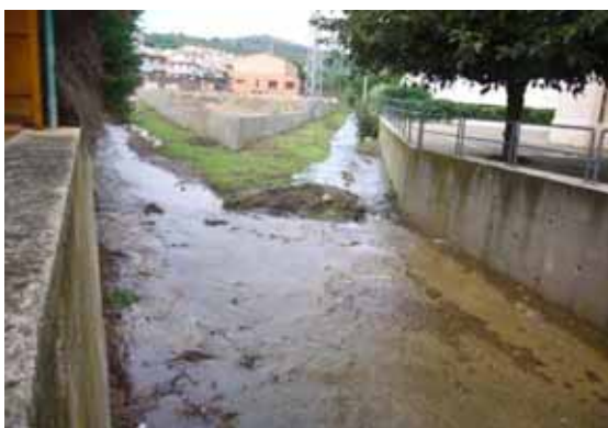
Foto F7.- Punt de confluència dels dos torrents després de les pluges de l'octubre 2010. (Foto PMR, octubre 2010).
