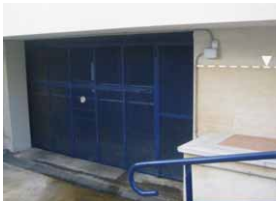
Foto B37.- Av. Mestral, porta del soterrani, on es veu el nivell assolit per l'aigua el 2006 (1,95 m sobre la solera del soterrani, uns 30 cm sobre el carrer). (foto PMR, novembre 2007)
