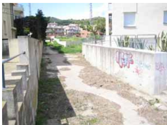
Foto F6.- Sediments sobre la solera de la canalització, aigües avall de la confluència dels dos torrents, alguns colonitzats per la vegetació. (Foto PMR, maig 2009).
