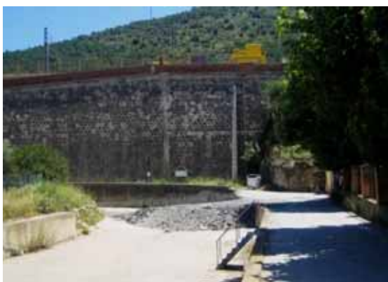
Foto P30.- Rampa de terres construïda per permetre la sortida dels vehicles de l'aparcament de dins la canalització; al fons el mur de la plataforma de l'estació. (foto PMR, juny 2008).
