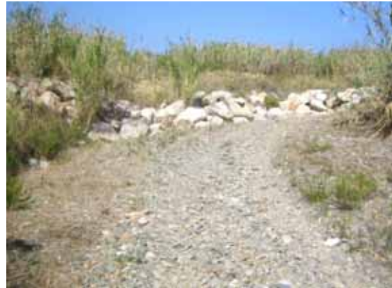
Foto S20.- Escullera a la riba esquerra, on és freqüent la ruptura de les aigües vers els conreus; notis que a la corba part dels blocs es troben remoguts ( punt S6 ). (foto PMR, setembre 2008)
