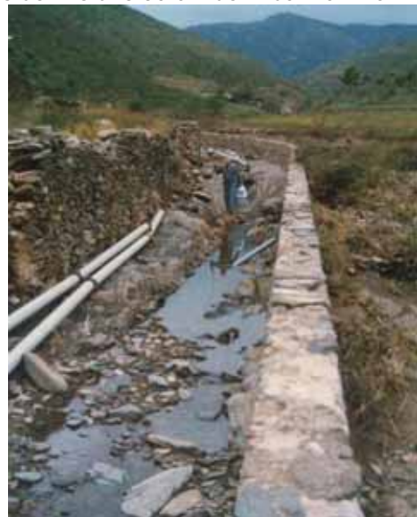
Foto P51.- Camí del pantà, erosionat amb les tubs de subministrament des de la presa malmeses i descobertes (Foto M. Roman, 1987)
