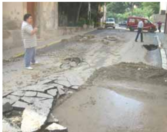
Foto E5.- Un altre punt de rebentament, deformació i ruptura del paviment pel mateix aiguat (entre la carretera i el C/ de Méndez Núñez; a l'esquerra l'antic edifici de l'ajuntament). (foto cedida per ajuntament).
