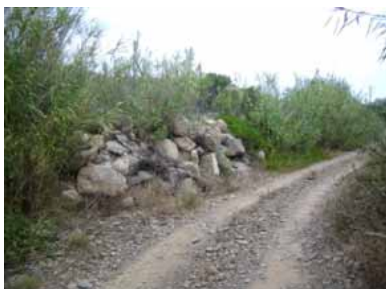
Foto B44.- Detall de la foto anterior del punt de desbordament per trencament de la mota esquerra del camí-llera, ara protegit per una matussera escullera. (Punt B4). (foto PMR, agost 2008).
