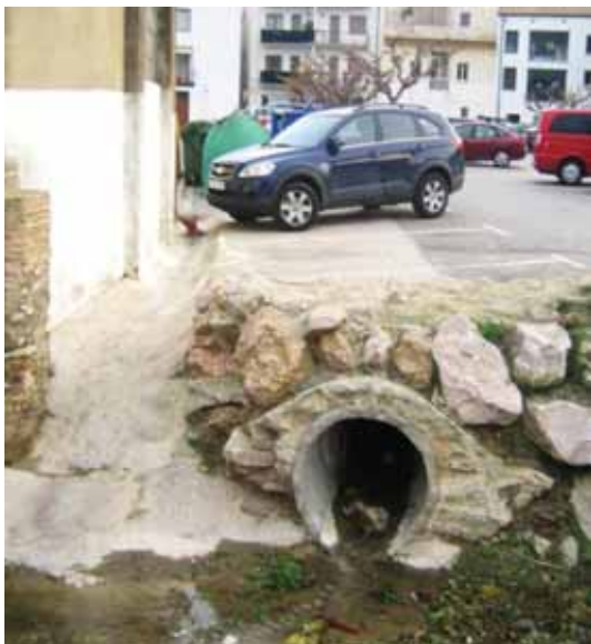
Foto L63.- Sortida de la canonada de drenatge de l'aparcament, al rec Madral, a ran de la caserna dels bombers. (foto PMR, gener 2008)
