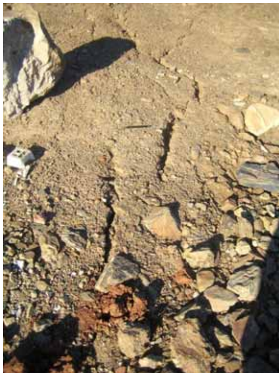
Foto B25.- Detall de les esquerdes de descompressió a la vora del talús, que van sent tapades per noves aportacions. (foto PMR, febrer de 2008).
