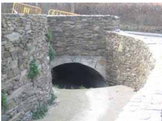
Foto Y9.- Boca d'entrada al tram soterrat de la canalització ( punt Y1 ) (foto PMR, febrer 2008)
