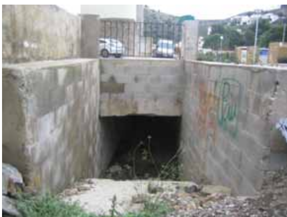
Foto C27.- Boca d'entrada infradimensionada al tram canalitzat del rec de la Murtra. (punt crític C16). (foto PMR, juny 2008).
