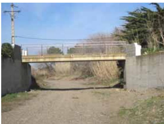
Foto S29.- Passera del càmping, en un tram entre murs de protecció ( punt S5 ) (9,25 m d'ample i 2,90 d'alt; secció 26,8 m 2 ). (foto PMR, març 2009)
