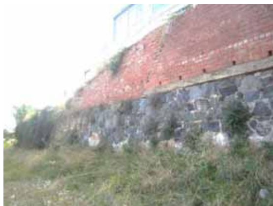
Foto L47.- Canalització lateral amb murs de diferent tipologia al sector dels horts de la riera de la Valleta. (foto PMR, setembre 2008)
