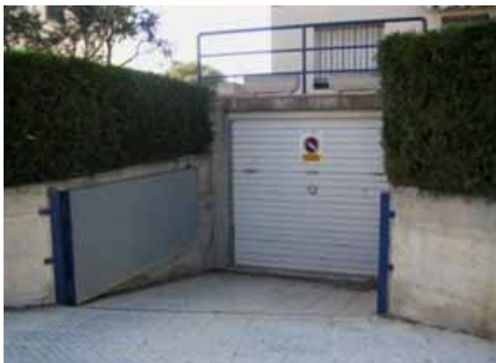
Foto B38.- Comporta de protecció de l'aigua, d'un batent, Av. Mestral.(foto PMR, novembre de 2007).
