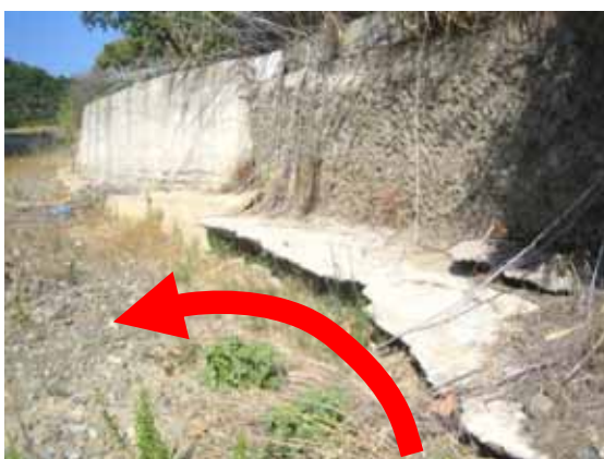
Foto S25.- Mur de protecció lateral, amb socavació del fonament en el tram de pedra seca. (foto PMR, setembre 2008)
