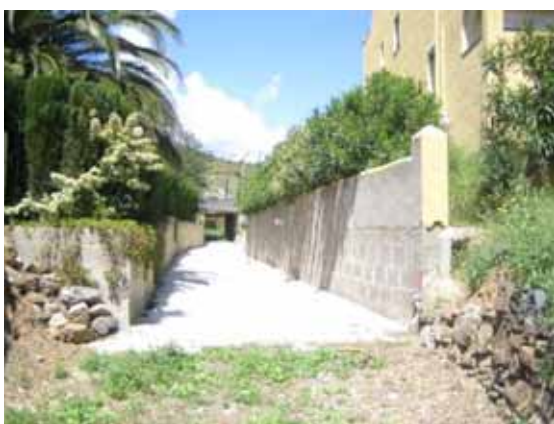
Foto F5.- Diferents tipus de canalització (torrent nord): aigües amunt amb solera i murs de diferents alçades i diferents tipologia d'obra, i en primer terme tram amb contenció de pedra seca i sense pavimentació. (Foto PMR, maig 2009).
