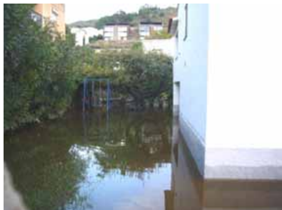
Foto S42.- Exterior d'habitatge inundat al carrer de la Selva, a la tarda del 13 d'octubre 2010, quan l'aigua ja es troba en descens. La línia gris fosc a la paret indica l'alçada assolida per l'aigua. (foto MAM)
