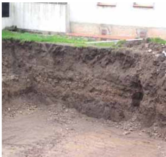
Foto C19.- Excavació per a construcció que va quedar inundada per surgència fins a la una tercera part de la seva fondària. En els talussos es poden veure els sediments fins, relativament permeables, deixats per anteriors rierades. (Sector històric C19.) (foto PMR)
