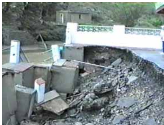
Foto C44.- Enfonsament del carrer de sobre del moll de la riba esquerra del port esportiu. (foto de l'endemà de la rierada, 4 d'octubre de 1987, extreta del video d'un turista desconegut).
