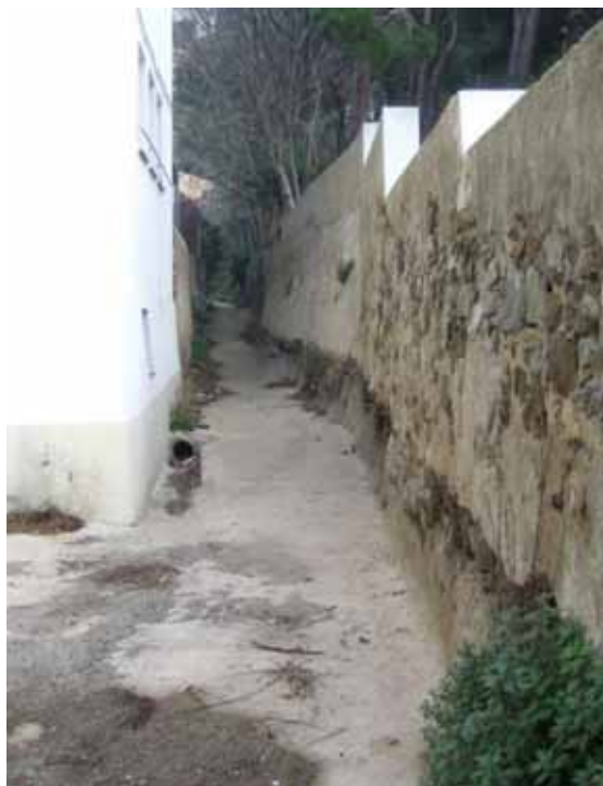
Foto Y8.- Final de la canalització entre una edificació i una paret de pedra.(punt Y2) (foto PMR, febrer 2008)
