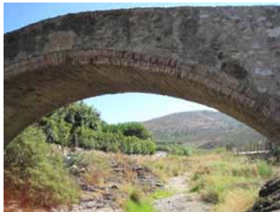
Foto L31.- Pont de la Valleta; noti's la "junta" de la reconstrucció posterior a la destrucció parcial del 1987 ( punt L7 ). (foto PMR, agost 2010)
