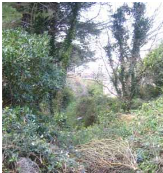
Foto Y6.- Detall de la vegetació que envaeix la llera, al tram alt (foto PMR, febrer 2008)
