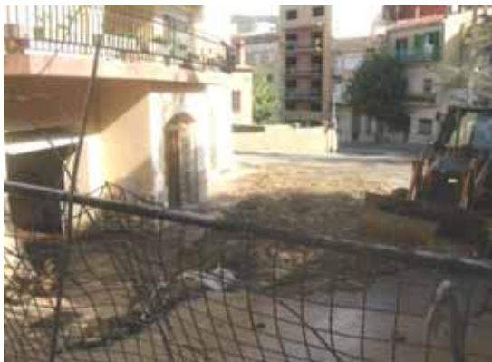
E9.- Pala excavadora enretirant els sediments acumulats a la façana de l'Av. Barcelona nº 31, durant el mateix episodi. (foto cedida per ajuntament).
