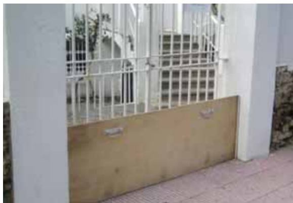
Foto Y18.- Detall de la protecció d'una reixa d'entrada al mateix restaurant El Xalet (foto PMR, febrer 2008)
