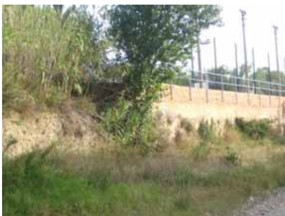
Foto L48.- Canalització lateral a la riba esquerra de la riera de la Valleta, al sector dels horts de les Salanques. (foto PMR, setembre 2008)
