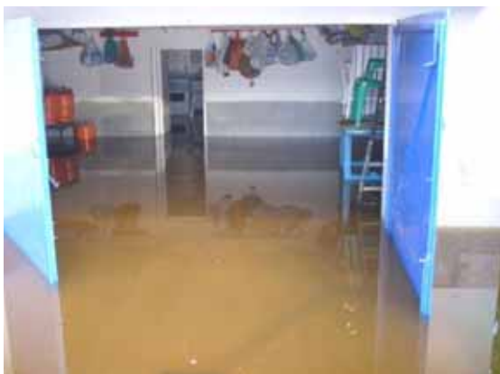
Foto S41.- Interior d'habitatge inundat al carrer de la Selva, a la tarda del 13 d'octubre 2010, quan l'aigua ja es troba en descens. La línia gris fosc a la paret indica l'alçada assolida per l'aigua. (foto MAM)
