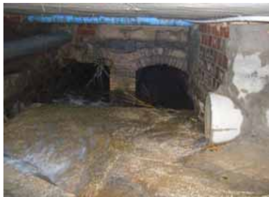
Foto Y14.- Interior de la boca de la foto anterior, on es veu l'arribada de dues canalitzacions laterals per la dreta i la posterior reducció de la capacitat del pas sota la carretera. (foto MAM, octubre 2010)
