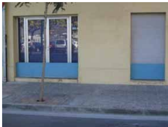
Foto L97.- Fustes fixes, collades a la paret, C/ Castellar. (foto PMR, novembre 2007)
