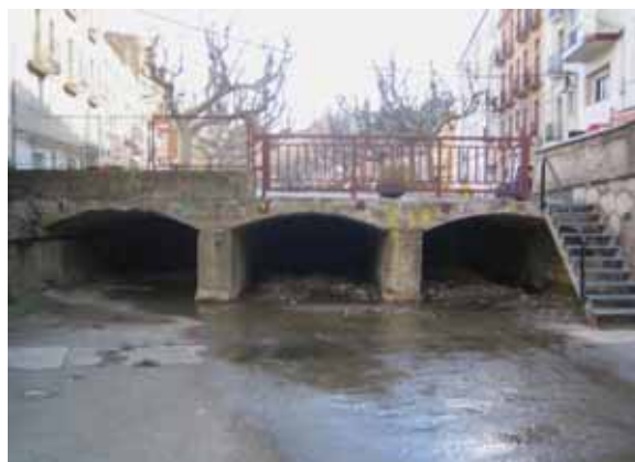
Foto P28.- Boca d'entrada del tram soterrat a la Rambla a l'hivern. Noti's la reducció del soterrament respecte a la canalització (foto PMR, gener 2008).
