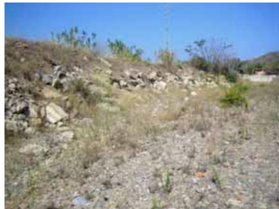
Foto S22.- Protecció lateral per blocs de pedra abocats, sense disposició en forma d'escullera; al damunt, mota de terres. (foto PMR, set 2008)
