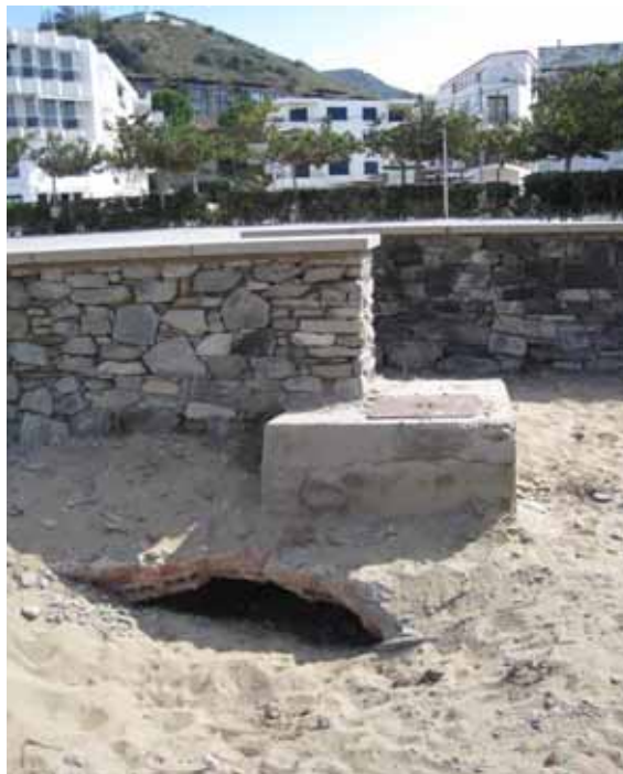
Foto Y3.- Sortida a la platja de la canalització soterrada que comença a l'embornal de Cal Mariner. Noti's que es troba bastant obturada. (foto PMR, octubre 2010).
