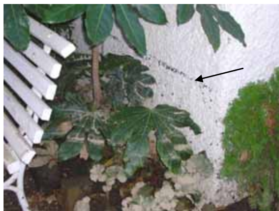
Foto S44.- Detall del jardí del restaurant el Xalet, amb indicació del nivell assolit per l'aigua el 13 d'octubre 2010. (foto MAM)
