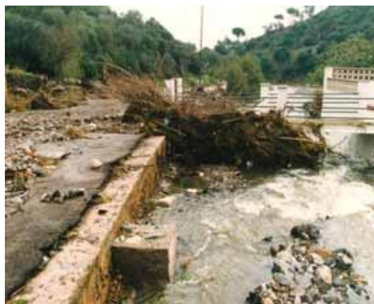
Foto P7.- Obturació de brossa en la primera passera de Vil·la Antònia, que fa desbordar l'aigua al camí situat a l'esquerra (Foto M. Roman, 8A, octubre 1987)
