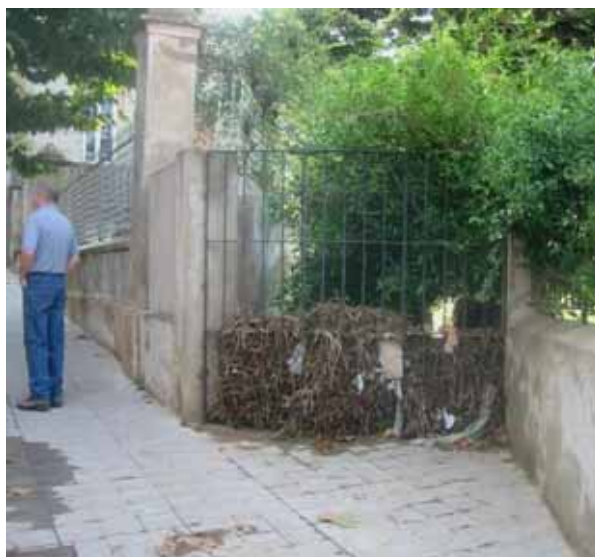
Foto E4.- Acumulació de brossa a la boca d'entrada del tram de soterrament ( punt E2 ) després de la inundació del 2006. (foto cedida per ajuntament).
