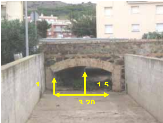
Foto F9.- Pont sota l'antiga traça de la carretera N-260 ( punt F5 ), el de dimensions més petites de tota la conc, susceptible de provocar obturacions i desbordaments. (Foto PMR, nov. 2008).
