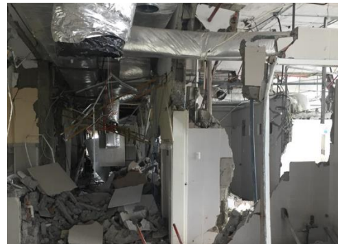
b) Daño en instalaciones. Caída de tuberías y ductos
