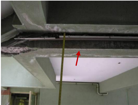
a) Daño estructural. Asentamiento del bloque
