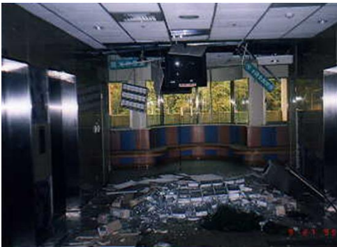
a) Daño en elementos arquitectónicos. Caída de techo falso y partición de bloques de vidrio
