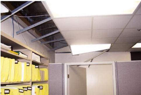
a) Daño en elementos arquitectónicos. Caída de falso techo y grietas en las particiones de yeso
