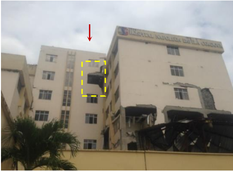
a) Daño estructural. Posible salida de la plomada en la planta superior
