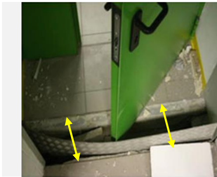
a) Daño estructural. Daño en la junta. Separación de bloques
