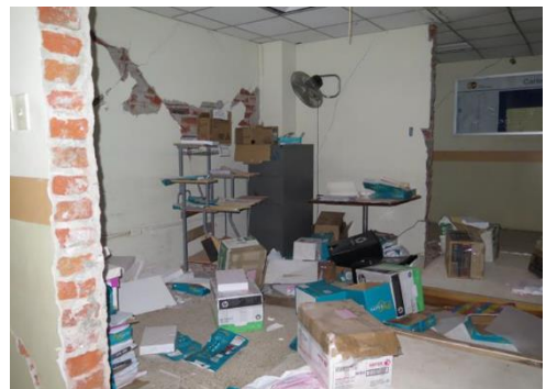
d) Daño en contenidos. Caída de mobiliario y accesorios
