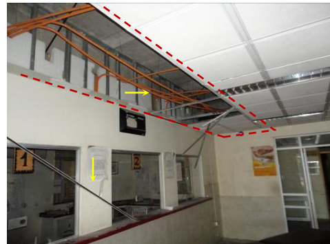
b) Daño en instalaciones. Caída del falso techo
