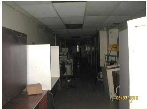
d) Daño en contenidos. Deslizamiento de contenidos en general
