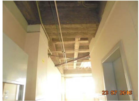
b) Daño estructural. Sin daño evidente
