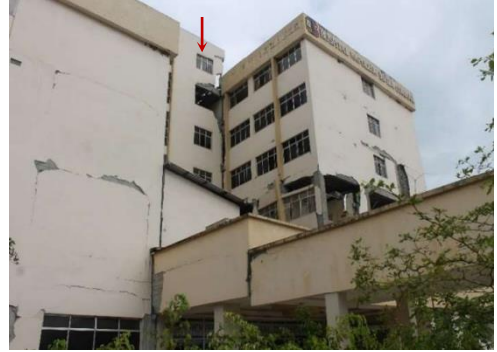
b) Daño estructural. Vista posterior. Deformación del Bloque 2
