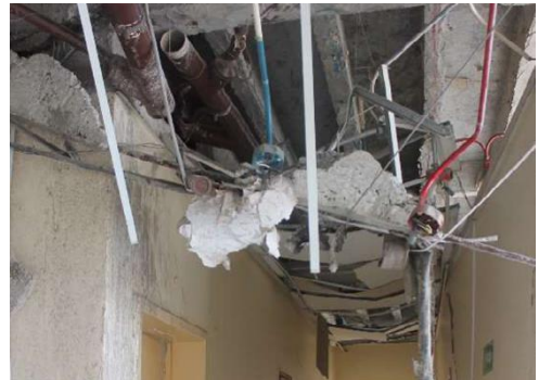
b) Daño en instalaciones. Daño en las tuberías
