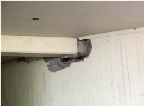
a) Daño estructural. Desprendimiento del revestimiento
