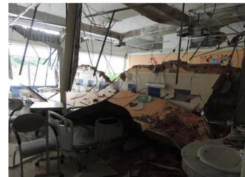
d) Daño en contenidos. Escombros sobre mobiliario
