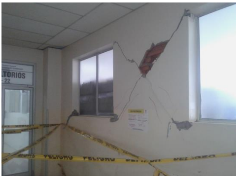
a) Daño en elementos arquitectónicos. Grietas diagonales en la mampostería
