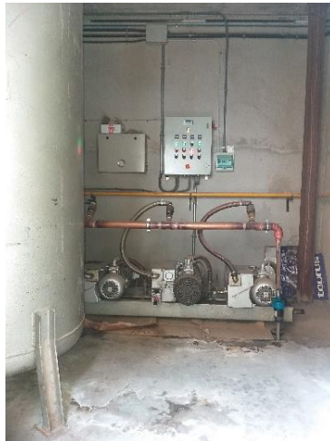
Figura 2-36. Sala de bombas de vacío
