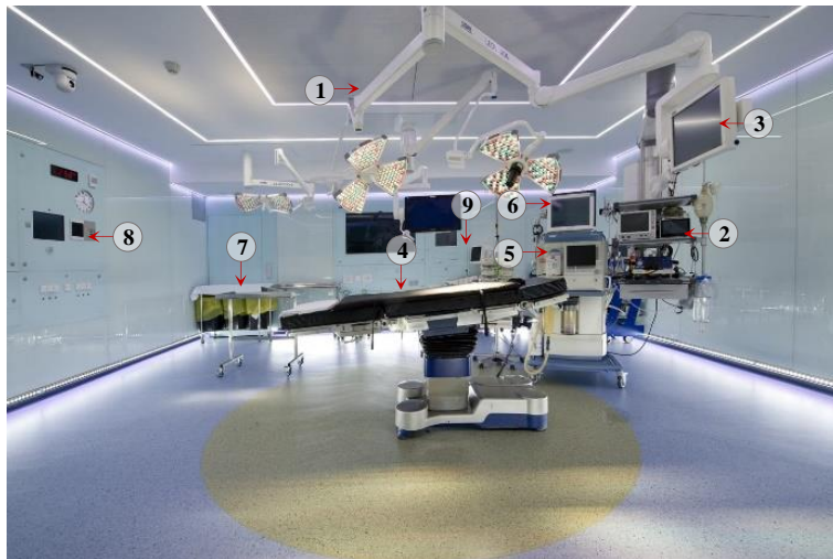
1. Lámpara quirúrgica; 2. Torretas de cirujano y anestésico; 3. Pantallas de visualización; 4. Mesa de operaciones; 5. Equipo de anestesia; 6. Bistrufi electrónico y monitores; 7. Mesas de instrumental; 8. Panel técnico
