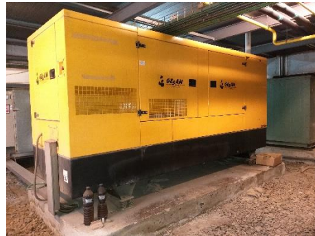
b) Grupo electrógeno
