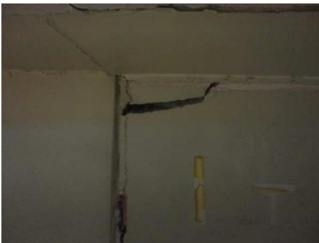
a) Daño en elementos arquitectónicos. Caída de techo falso y partición interior
