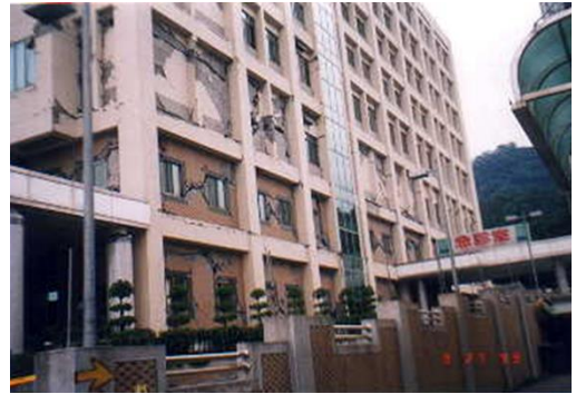
b) Daño estructural. Sin daño visible. No obstante, daño visible en fachada
