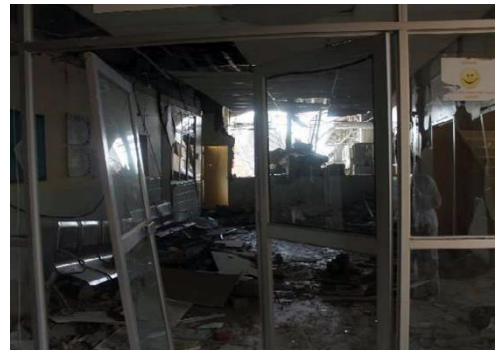
d) Daño en contenidos. Escombros sobre mobiliario
