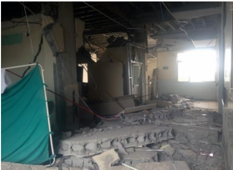
a) Daño en elementos arquitectónicos. Caída de particiones interiores
