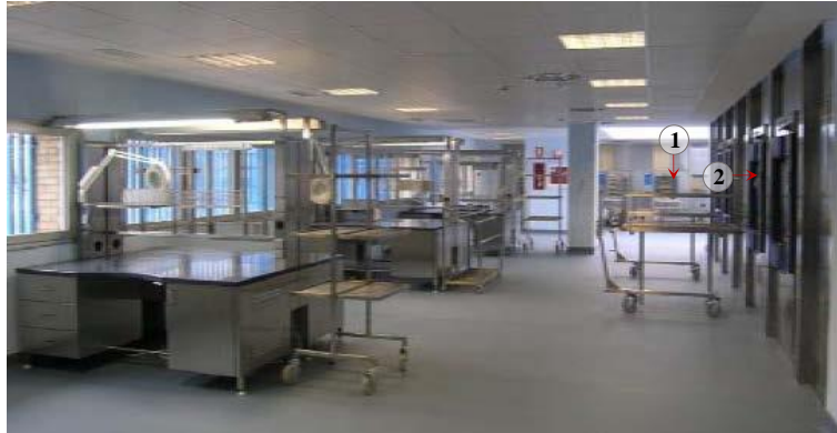
1. Lavadora desinfectadora; 2. Autoclaves de vapor y de baja temperatura
