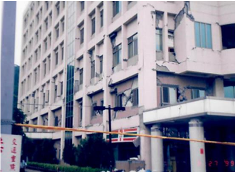
a) Daño estructural. Sin daño visible. No obstante, daño visible en fachada
