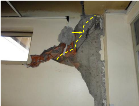
a) Daño estructural. Armadura descubierta en una columna de hormigón
