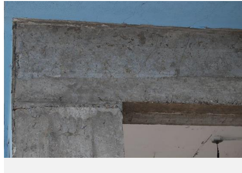
b) Daño estructural. Fisuras en un nudo viga-columna
