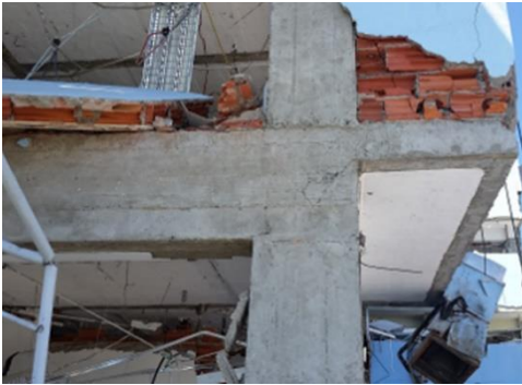
a) Daño estructural. Fisuras en un nudo viga-columna
