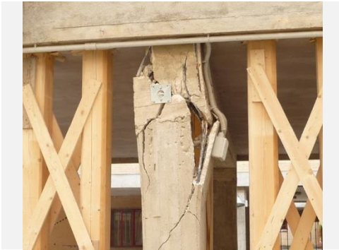
a) Daño estructural. Falla de corte en una columna
