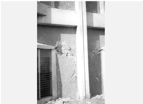
a) Daño en elementos arquitectónicos. Grietas diagonales en mampostería
