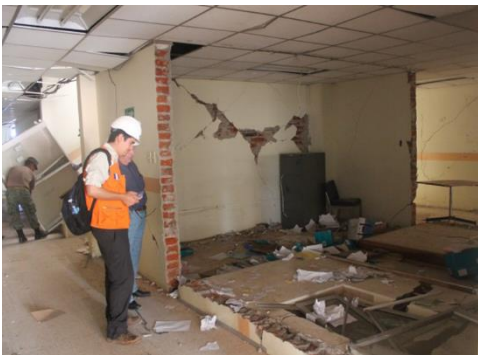
a) Daño en elementos arquitectónicos. Caída de una partición interior
