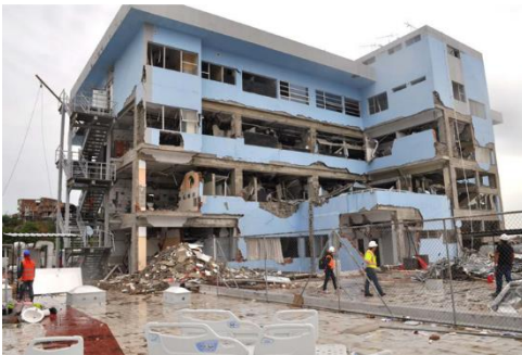
a) Daño en elementos arquitectónicos. Daño en fachadas y acristalamiento
