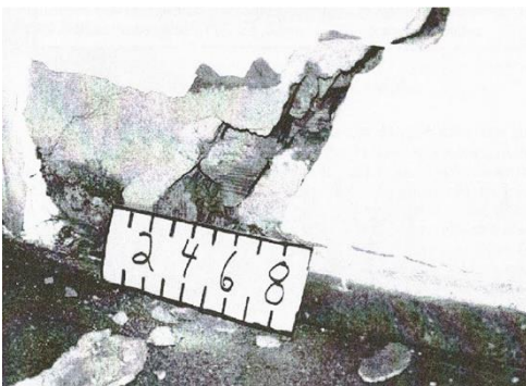
a) Daño en elementos arquitectónicos. Daño en mampostería exterior (envolvente)
