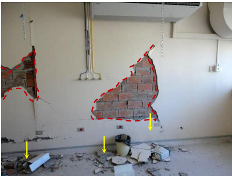
a) Daño en elementos arquitectónicos. Desprendimiento de acabados
