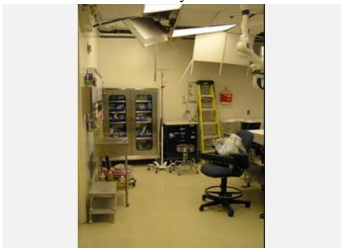
c) Daño en equipamiento médico. Sin daño aparente (Quirófano)
