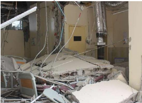
c) Daño en equipamiento médico. Caída de escombros en hospitalización
