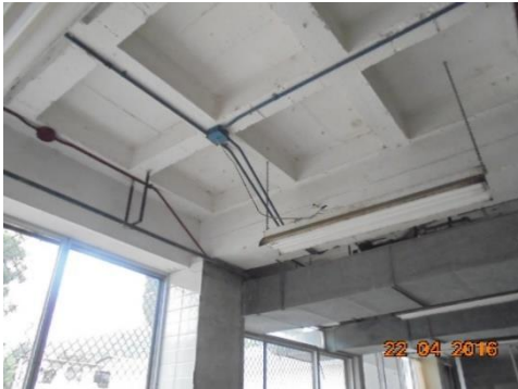
a) Daño estructural. Sin daño evidente
