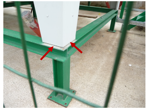
b) Daño en instalaciones. Ligero desplazamiento en equipos de climatización
