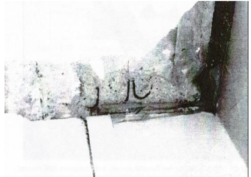
b) Daño estructural. Daño en junta
