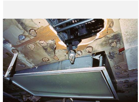
b) Daño en instalaciones. Rotura de tuberías de red de incendios (fuga de agua)
