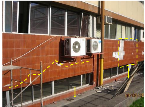
b) Daño estructural. Daño en una viga perimetral externa de la planta baja
