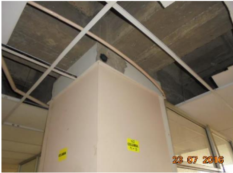
a) Daño estructural. Sin daño evidente
