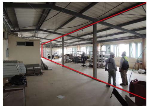
d) Daño en contenidos. Caída de escombros en oficinas de administración
