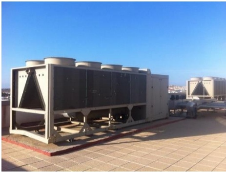
a) Máquina enfriadora
