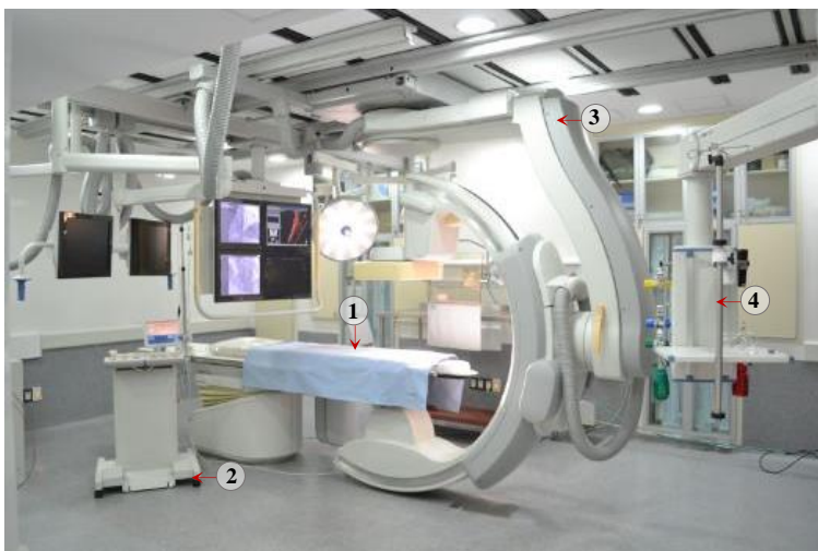
1. Mesa de tratamiento; 2. Equipos apoyados; 3. Equipos colgados; 4. Torreta colgada
