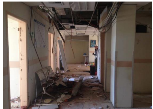
b) Daño en instalaciones. Rotura de cables y tuberías
