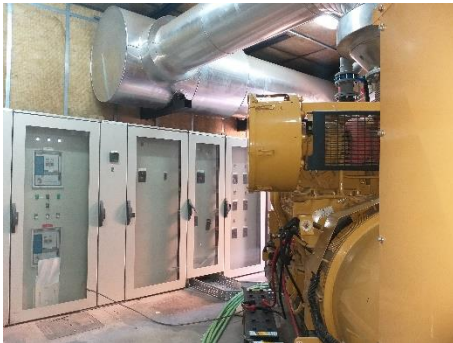
a) Recinto del grupo electrógeno
