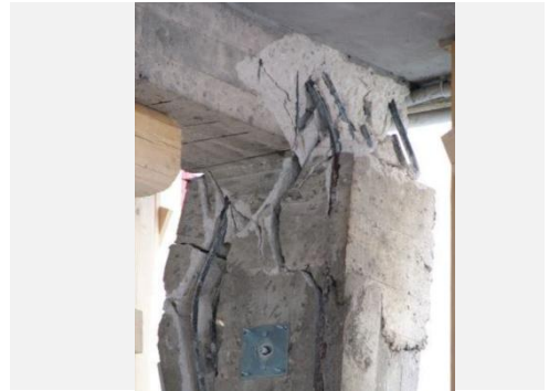
b) Daño estructural. Ausencia de refuerzo transversal en una columna
