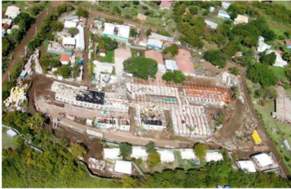
Fotografía 28. Construcción primera etapa Hospital Hanga Roa, 2010. Se distingue el antiguo HHR - humilde- hacia el fondo. Fuente: Cuenta pública HHR 2011.
