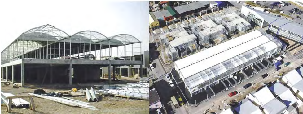
Fig. 117-119 Lacaton y Vassal. 2001-2005 Edificio de 14 viviendas en Mulhouse Emplazamiento, imagen de la construcción, imagen aérea
