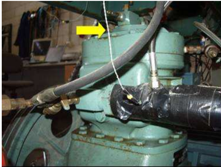
Fig. 4.28. Sonda de temperatura en la aspiración del compresor.
