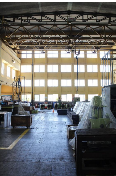
31 José Ferragut Pou. Central Tèrmica de GESA, original. Interior. Fotografia de l'autor.
