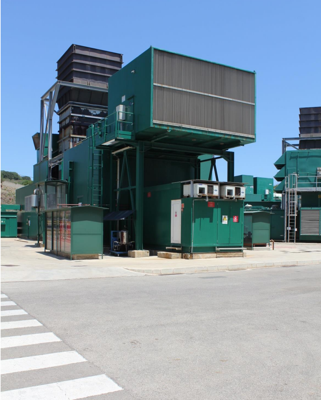
38 Turbines a gas de la Central Tèrmica. Fotografia de l'autor.
