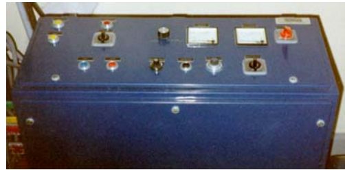
Foto 11: Bancada de control del grupo motor de frecuencia variable.
