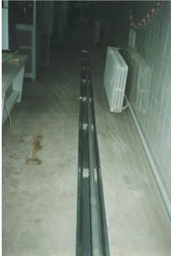
Foto. 3 : Carril inducido, instalado en los laboratorios de Máquinas eléctricas de la E.T.S.E. - U.R.V.
