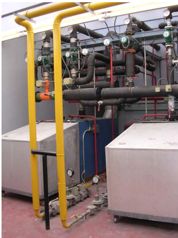
Fig. 3.1.14. Cuarto de calderas edificios A-5 y A-6
