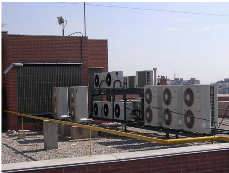
Fig. 3.1.13. Equipos de refrigeración en cubierta módulo D-4
