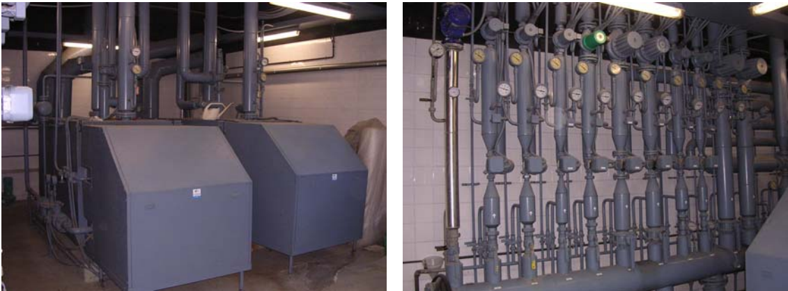
Fig. 3.1.1 Cuarto de calderas EPSEB
