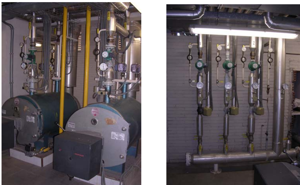
Fig. 3.1.11. Cuarto de calderas edificio D-4
