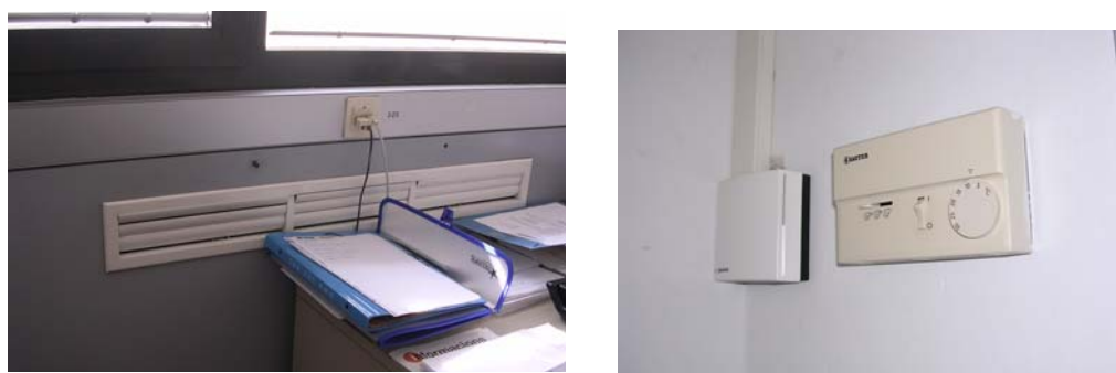
Fig. 3.1.8 Unidades FAN-COIL en despachos, y sondas de temperatura módulo C-3.
