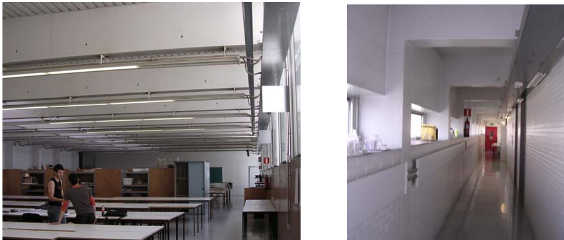
Fig. 3.1.6. Emisores en aulas y pasillos ETSAV
