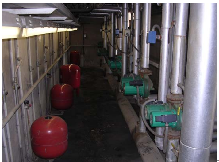
Fig. 3.1.9. Cuarto de calderas y refrigeración edificio C-3
