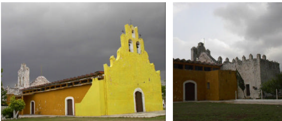
Figura 61. Capilla de Visita de Dzilán González. Falta de integridad formal entre las diferentes etapas constructivas.
