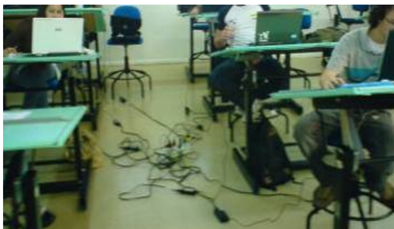
Figura 52 Clase de proyectos y conflicto con las instalaciones eléctricas para notebooks (fotografía del autor 2011).
