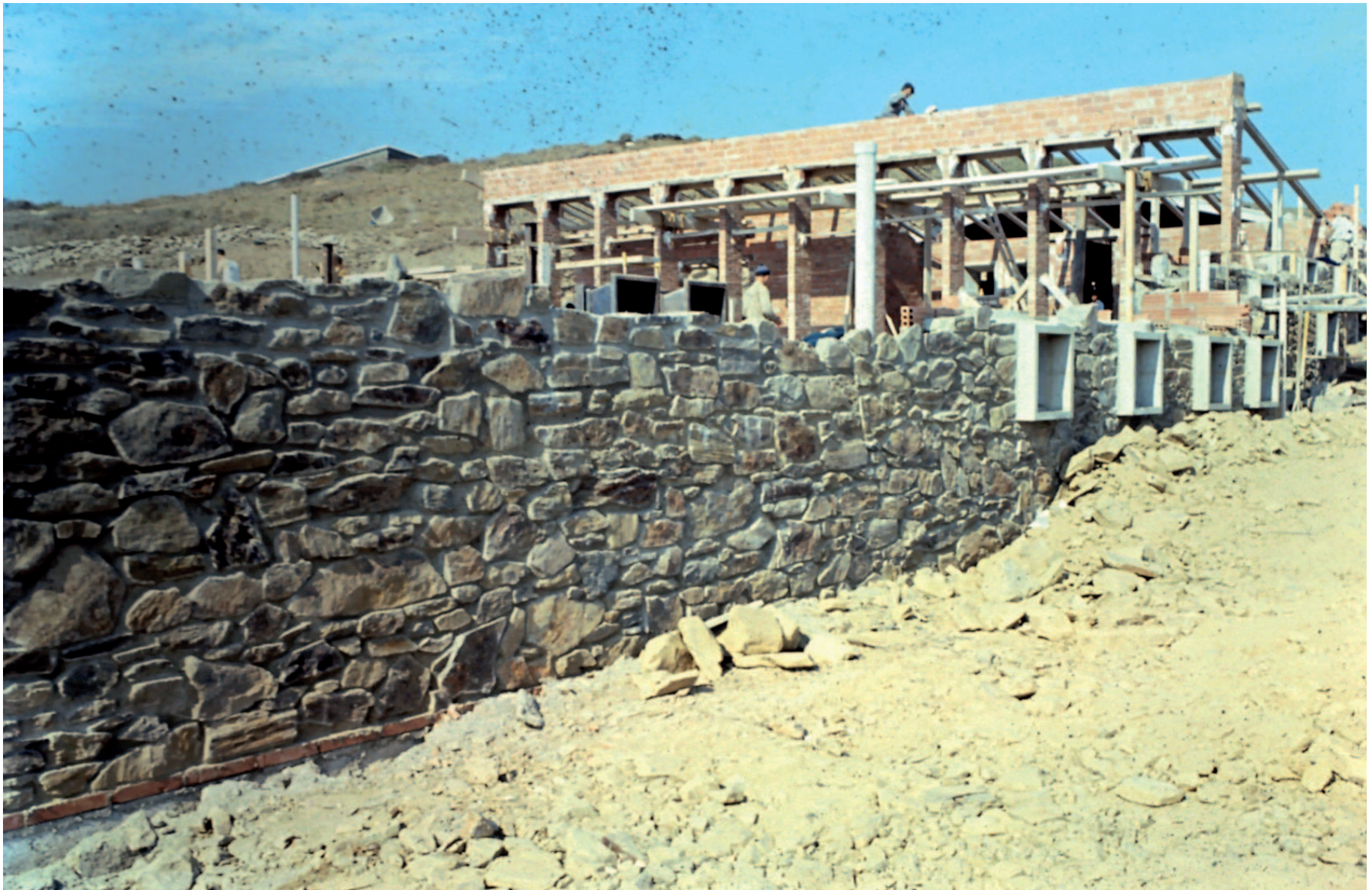
Els murs de càrrega són de pedra del Cap de Creus recuperada de les obres d'ampliació de la carretera. En el segon pla, es veuen els pilars de la llibreria estructural.
