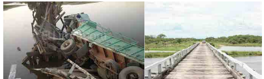
Antiguo puente de madera. Diario El Litoral 10-10-2010. "Tránsito cortado. Colapsó el puente de la ruta provincial 73 S sobre el arroyo Saladillo Dulce." [en línea] Consultado. 09/05/2012. www.ellitoral.com/index.php/id_um/57109 y Panoramio
