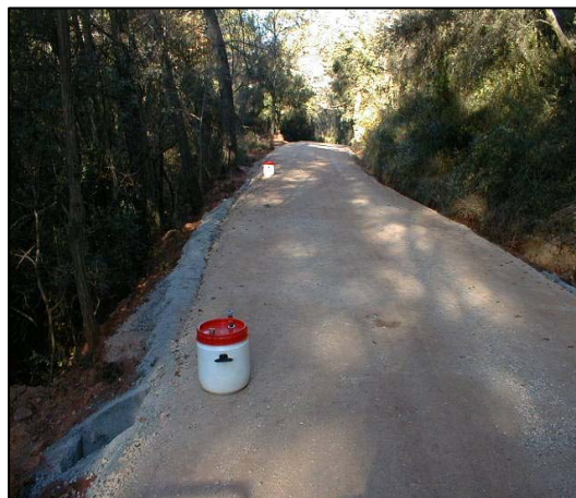
Foto 5.13: Bidón de recogida de lixiviados.
