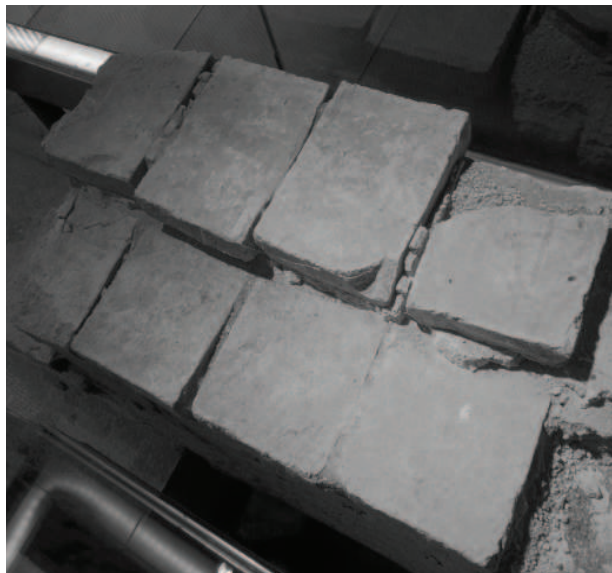
Fig. 110. Un dels murs de la "Casa de la Columna", on predomina l'ús del maó cuit. La tècnica constructiva es basa en la col·locació de dos maons lligats amb argamassa per a completar tota l'amplada del mur (A. Perich).
