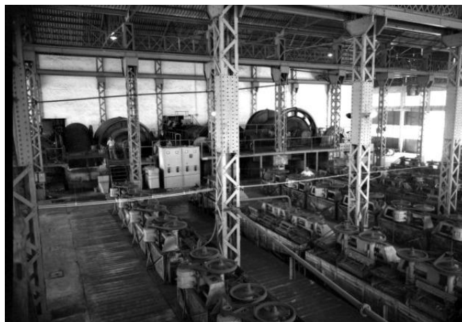
Figura 1. 16. Interior del Lavadero Roberto, con los molinos de bolas al fondo, donde se tritura el material y en primer término las celdas donde se forma la espuma y se separan los estériles (Archivo General de la Región de Murcia, 2014).
