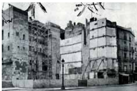
198. Av. de la Catedral. Derribo de las casas y reconstrucción de las torres. 1957. Fuente: Florensa, 1958-C.
