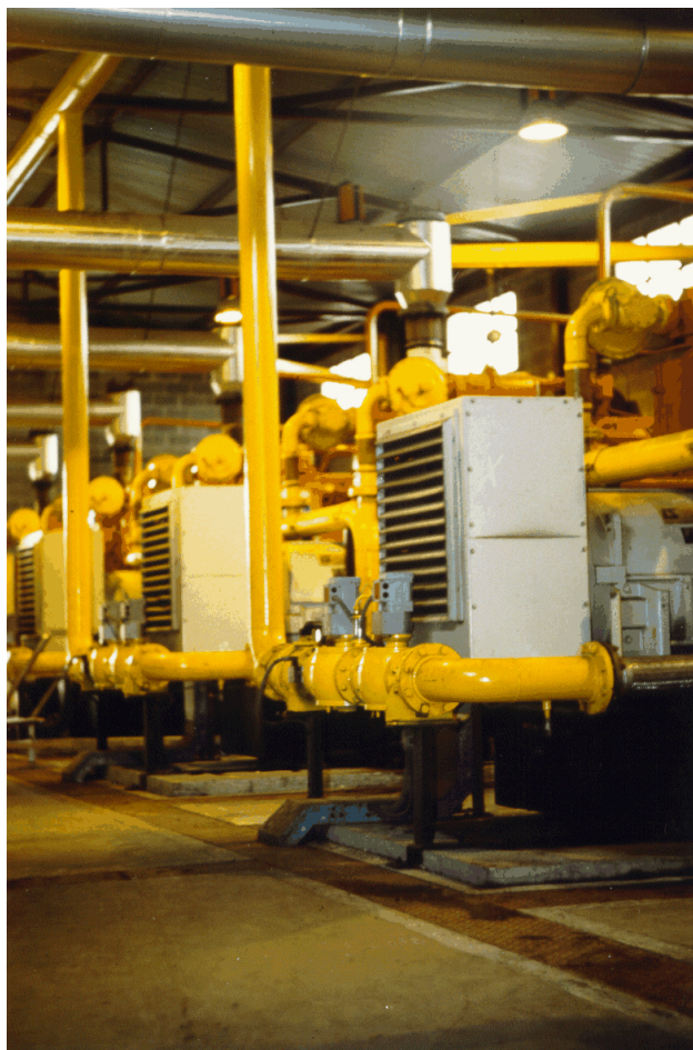
Fotografía A7. Planta de generación de electricidad para la venta a la red eléctrica (La Zoreda)
