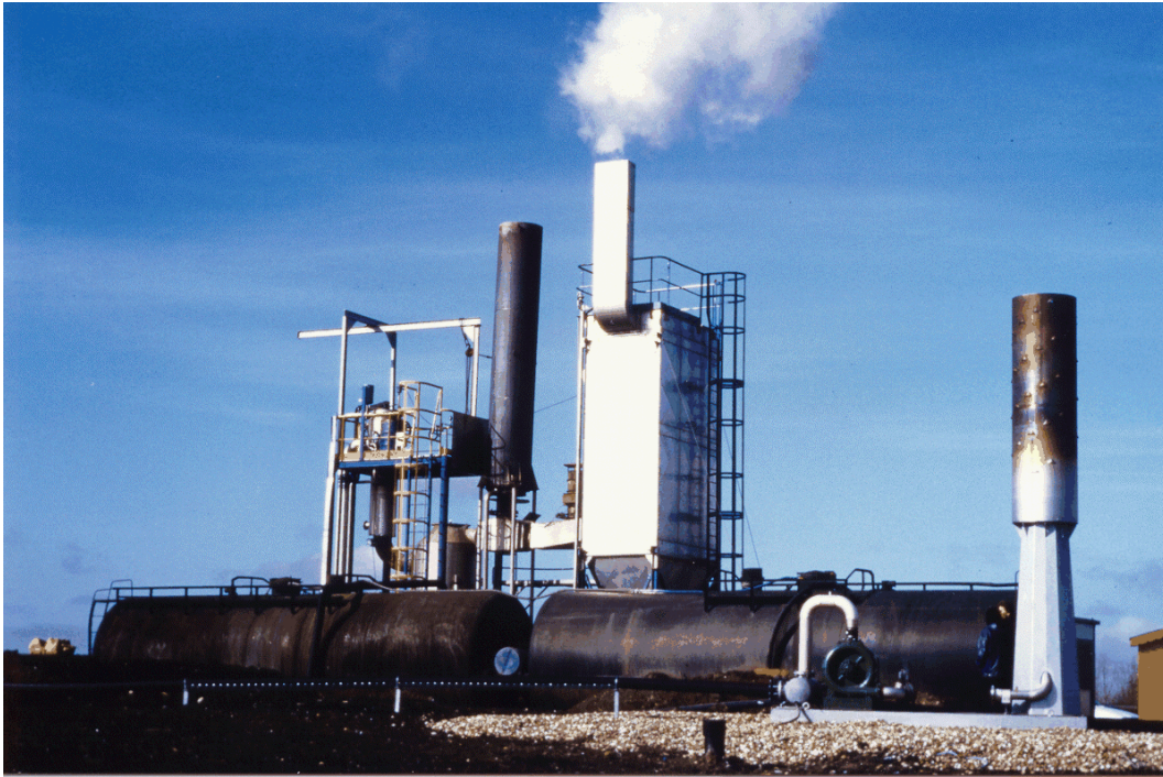
Fotografía A1. Evaporador de lixiviados alimentado con biogás (vertedero de Soignolles en Brie, Metz, Francia)
