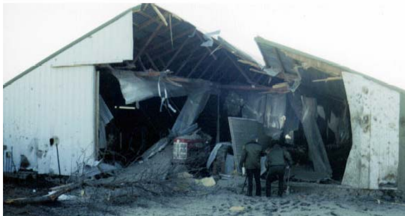
FIGURA 3.10. Daños producidos en una nave (A) por el impacto del fragmento de la figura 3.11 en Albert City (Iowa) en 1998 (CSB, 1999).
