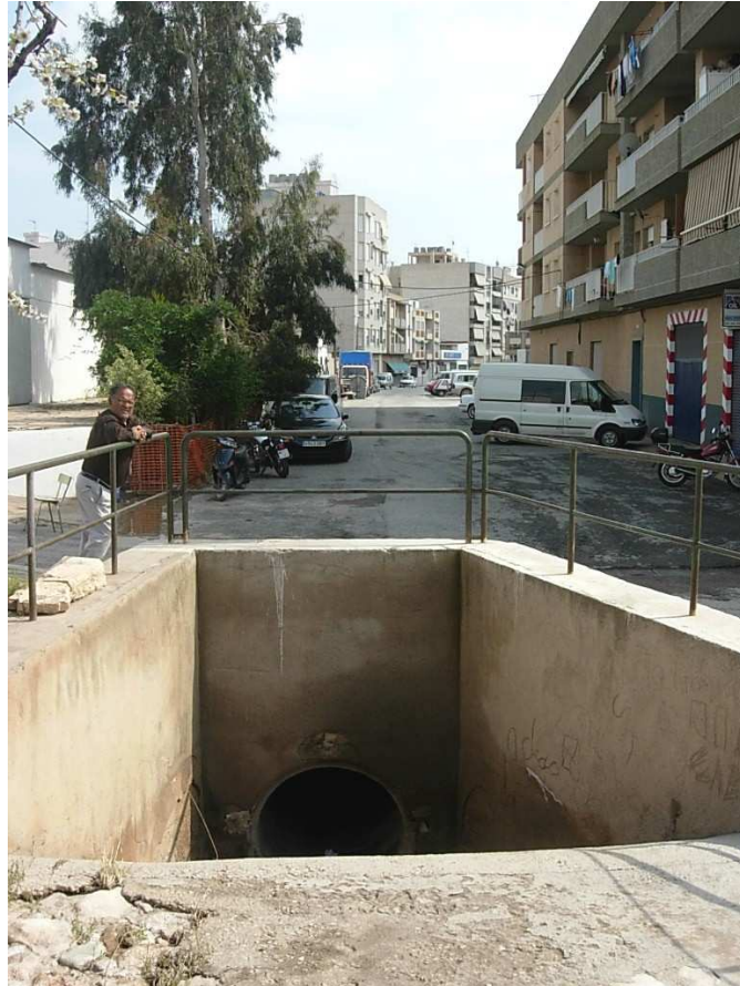
Fig. II.114 Entubación de la rambla de Las Majadas a su entrada en el casco urbano de Águilas
