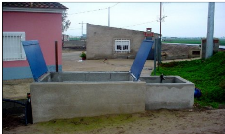
Fig. 134. Arqueta de contadores (C.R. Lorca)
