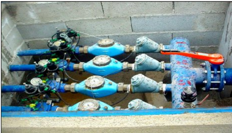
Fig. 135. Batería hidrante (C.R. Lorca)
