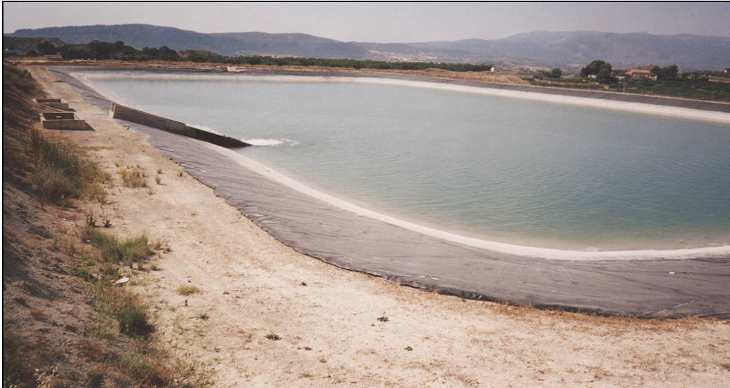
Fig. 110. Embalse para el riego localizado (tierras altas del municipio de Lorca)
